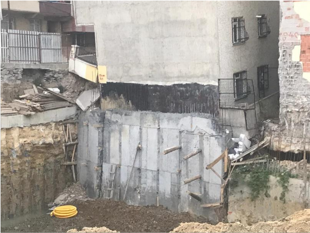
Resim-6 12 parseldeki binanın dönmesi ve kuyu perdenin işlevsizliği
