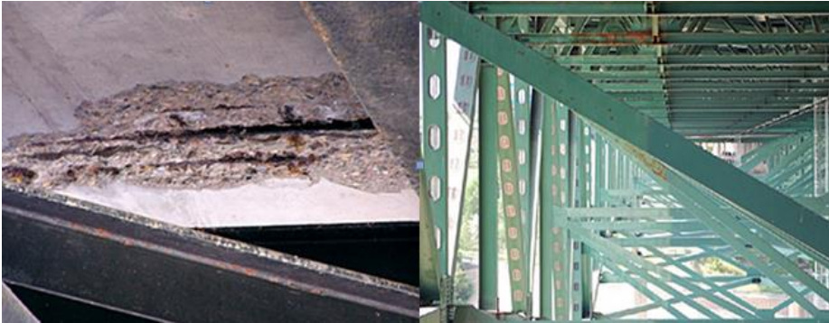
Şekil 2. I-35W köprüsü çökmeden önce kaydedilmiş korozyon kaynaklı hasarlar (web site 1, 2007)
