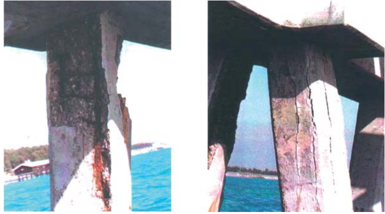
Şekil 1-BOTAŞ-Ceyhan Dörtüyl İşletme Tesislerindeki Donatı Korozyonu[4].
