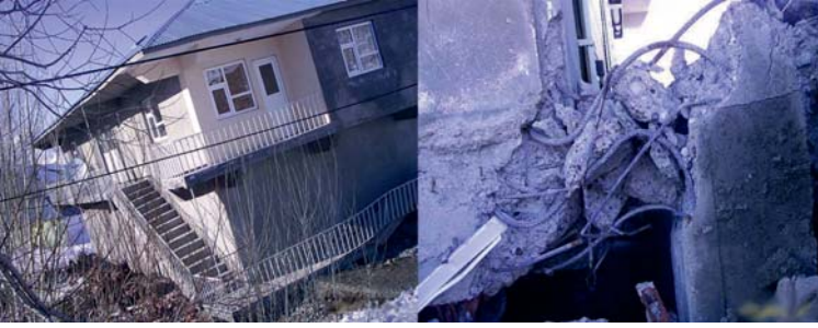
Şekil 3 - 3 Katlı Karkas Bir Yapının Dere Yatağına Doğru Eğilmesi ve Kötü Beton ve Demir İşçiliği Sonucu Bir Kolonun Çözülmesi (Çatak)
