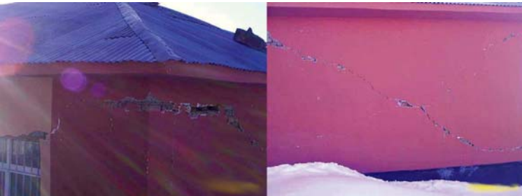
Şekil 5 - Çatak İlköğretim Okulu Köşe, Pencere ve Duvarda Oluşan Hasar
