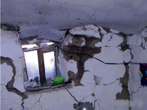
Şekil 6 - Tipik Bir Köy Konutunda Meydana Gelen Bir Hasar Örneği (Viranşehir)
