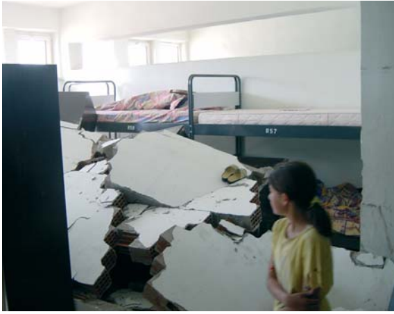
Resim 8 - Döşemeye Oturan ve Çerçeve İçinde Olmayan Bölme Duvarın Yıkılması (1 Mayıs 2003 Bingöl Depremi)
