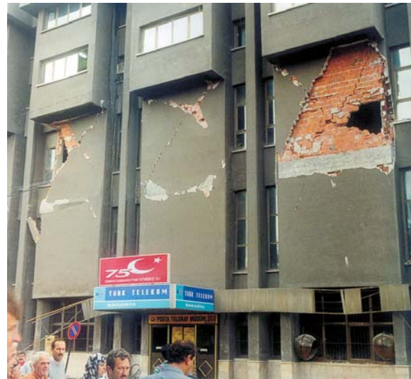
Resim 12 - Sandviç Duvarda Bağlanmamış İç ve Dış Duvarlar Düzlem Dışına Devrilebilir (17 Ağustos 1999 Adapazarı Depremi)
