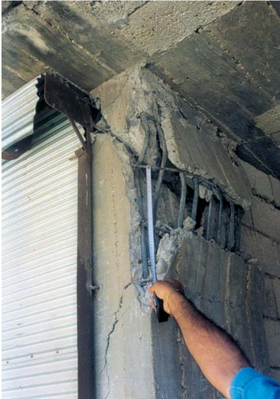
Resim 5 - Kolon Kesme Kırılmasından Sonra Düşey Yük Taşıyan Briket Dolgu Duvarı (27 Haziran 1998 Adana-Ceyhan Depremi)
