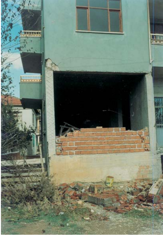
Resim 1 - Dolgu Duvarı Tümü ile Yıkılmış Çerçeve Açıklığı (1 Ekim 1995 Dinar Depremi)
