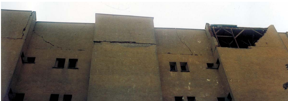
Resim 10 - Yüksek Kalkan Duvarların Hasarı ve Düzlem Dışına Devrilmesi (27 Haziran 1998 Adana-Ceyhan Depremi)
