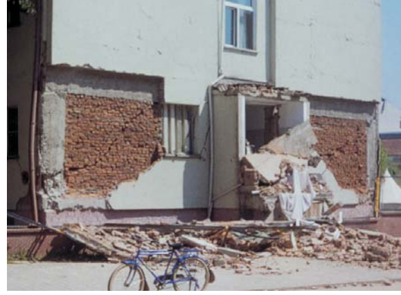
Resim 16 - Betonarme Çerçeve ile Birlikte "Perde Duvar" Gibi Deprem Yüğü Taşımış Dolgu Duvar (17 Ağustos 1999 Düzce Depremi)
