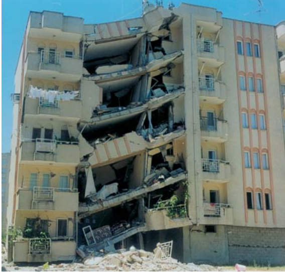
Resim 4 - Zemin Katında Dolgu Duvarsız Bölümü Yıkılan Duvarlı Bölümü Yıkılmayan Yapı (27 Haziran 1998 Adana-Ceyhan Depremi)
