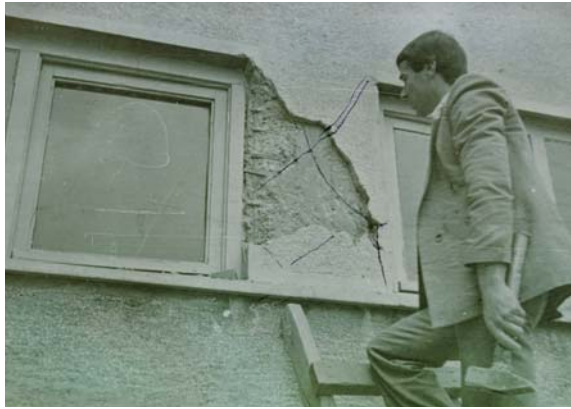
Resim 15 - Bant Pencere Bölümü Sık Etriye Kolonda Beton Çatlar Ancak Kısa Kolon Kırılması Olmaz (18 Kasım 1983 Erzincan Depremi)
