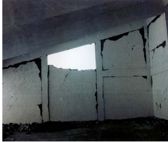
Resim 6 - Orta Açıklıktaki Yüksek Dolgu Duvarını Düzlem Dışına Devrilmesi, Ara Kirişli Duvar Devrilmemiş (6 Eylül 1975 Lice Depremi)
