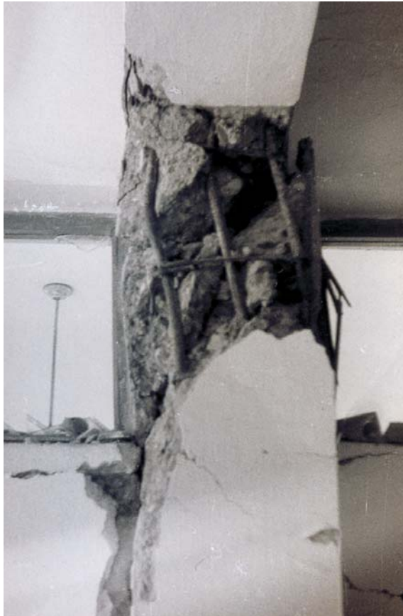
Resim 13 - Kısa Kolon Kırılması (22 Mayıs 1971 Bingöl Depremi)
