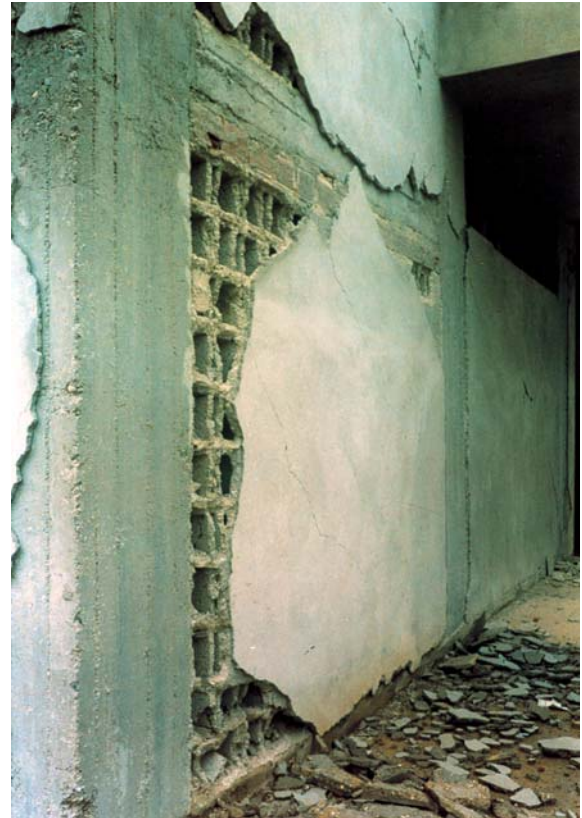
Resim 3 - Düşük Dayanımlı Briket Dolgu Duvarı Hasarı (27 Haziran 1998 Adana-Ceyhan Depremi)
