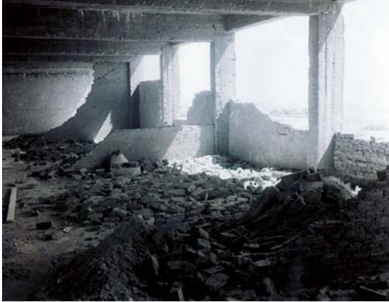
Resim 7 - Döşemeye Oturan ve Çerçeve İçinde Olmayan Bölme Duvarın Yıkılması (6 Eylül 1975 Lice Depremi)
