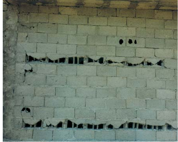
Resim 2 - Düşük Dayanımlı Briket Dolgu Duvarı Hasarı (27 Haziran 1998 Adana-Ceyhan Depremi)
