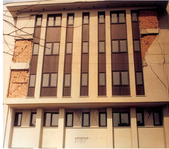
Resim 11 - Sandviç Duvarda Bağlanmamış İç ve Dış Duvarlar Düzlem Dışına Devrilebilir (13 Mart 1992 Erzincan Depremi)
