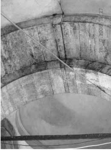
Şekil 3.3 Camii İçinde Kemerlerde Oluşan Çatlaklar
