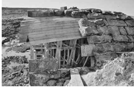
Foto 10 Kemerde sökülen bölüm
