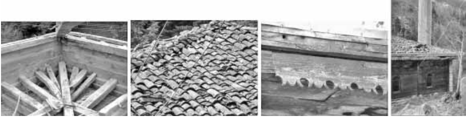
Şekil 8 Onarım öncesi çatı (Çaykara-Taşkiran Beldesi Camii)
