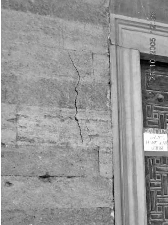
Şekil 3.1 Kapı Kenarlarında Oluşan Çatlaklardan Biri
