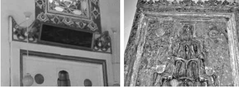
Şekil 6 Mihrabın onarım öncesi ve sonrası durumu
