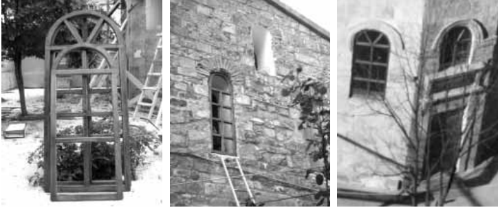
Şekil 14 Yenilenmiş pencere doğramaları.
