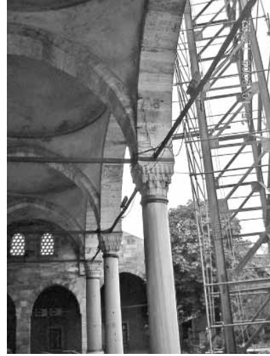
Şekil 3.4 Son Cemaat Kısımında Ayaklarda Oluşan Çatlaklar
