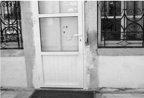
Foto: 5. İzmir, Kemeraltı Camii. Kütüphanenin batı duvarında kapı ve sövelerdeki yanlış malzeme seçimi.
