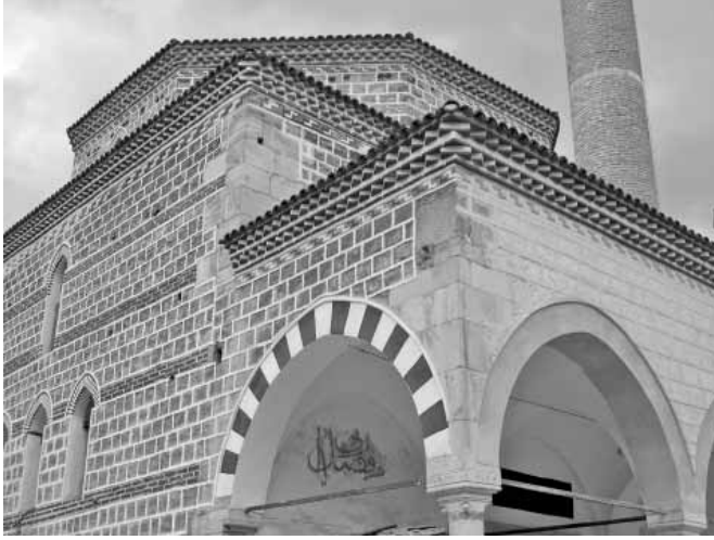
Fotoğraf 6: Saframbolu’da bir Osmanlı Camisi. Kabarik ve renkli derz uygulaması. Derz ve tuğla taklidi harçlar yağlı boya ile renklendirilmişlerdir.
