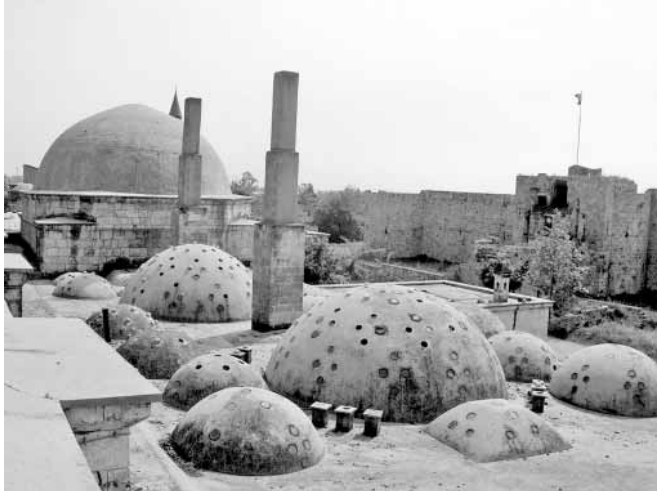
Fotoğraf 11: Sokollu Külliyesi (16. yüzyıl). Onarımda bütün örtü yüzeyleri çimento ile kaplanmıştır.
