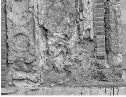
Fotoğraf 13: Malatya Ulu Camii (13. yüzyıl). Önceki onarımlarda çimento kullanımı, özensiz ve çirkin.
