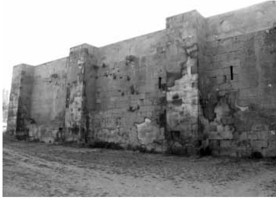
Fotoğraf 9: Ağzı Karahan (Aksaray Nevşehir Arasında, 13. yüzyıl). Eski onarımlarda çimento kullanımından kaynaklanan tuz çıkışı.
