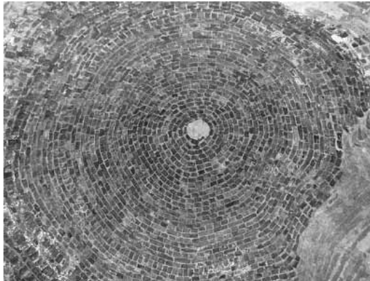
Fotoğraf 10: Beypazarı Boğazkesen Türbesi (13. yüzyıl). Onarımda çimento kullanımına bağlı tuz çıkışı.
