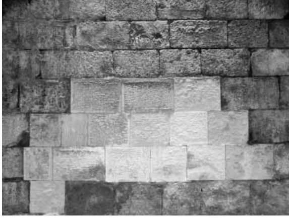
Fotoğraf 8: Payas Sokollu Külliyesi (16. yüzyıl). Onarımda kullanılan yapay taşlar, özgün taşlara oranla daha çabuk tahrib olmuş, ufalanmışlardır.
