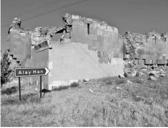
Fotoğraf 4: Alay Han (Aksaray Nevşehir Arasında, 13. yüzyıl). Onarımda renk ve doku bakımından aşırı farklı malzeme kullanılmıştır.
