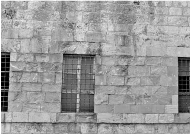
Fotoğraf 7: Payas Sokollu Külliyesi (16. yüzyıl). Onarımda kullanılan yapay taşlar, özgün taşlara oranla daha çabuk tahrib olmuş, tabakalar halinde dökülmüşlerdir.
