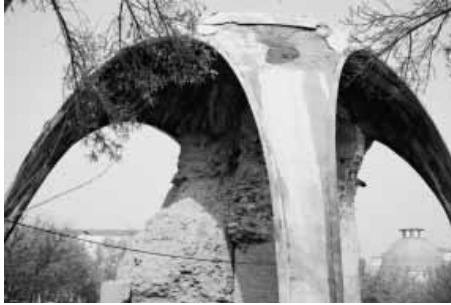
Şekil 9. Köşkün üzerindeki koruyucu kabukta bozulmalar görülmüştür.
