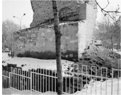
Şekil 14. Zeminden yükselen yağış suları görünüşü
