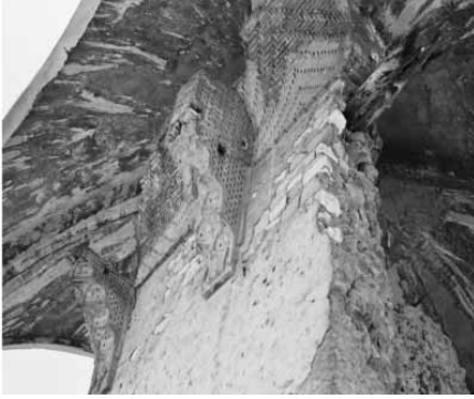
Şekil 15. Konsol tuğla ve ahşap kiriş tavana yağış suları akıntıları
