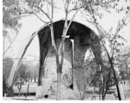
Şekil 8. Köşkün duvarı yıkılmak üzeredir
