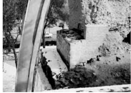
Şekil 12. Kar suları ve zeminden yükselen suların görünüşü
