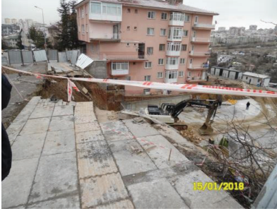
Resim-2 Çökmüş kaldırım ve yolda hasar. Diğer yönden görünüşü
