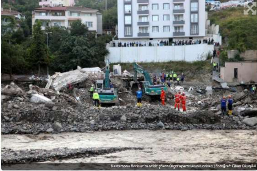
Kastamonu Bozkurt'ta selde çöken Ölger apartmanının enkası | Fotoğraf: Ghan Okur/AA
