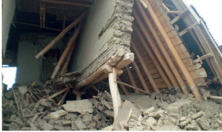
Şekil 6 - Tabanözü köyündeki hasar görmüş kerpiç yapı
