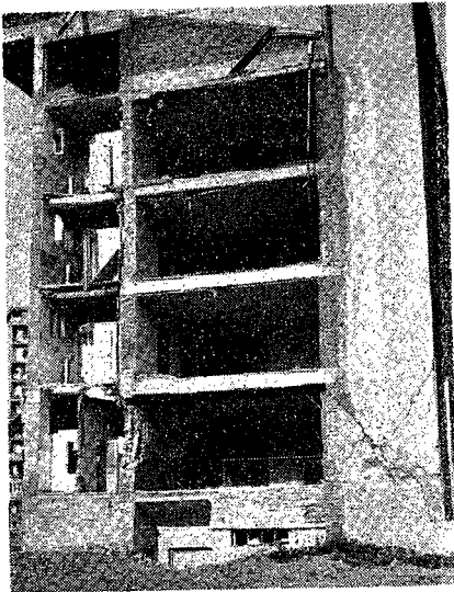
Şekil : 4 Boyuna taşıyıcı duvarlı yığma kârgir bir binada deprem hasarı.
