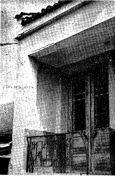
Hasara uğrayan kısım
