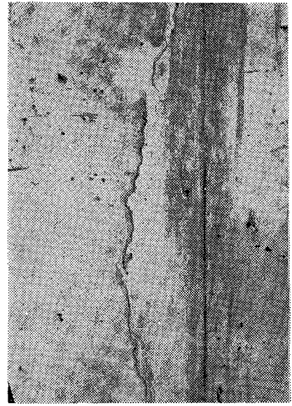
Şekil 15 : Bir çıplak beton duvarın sathında rötreden doğan çatlaklar.
