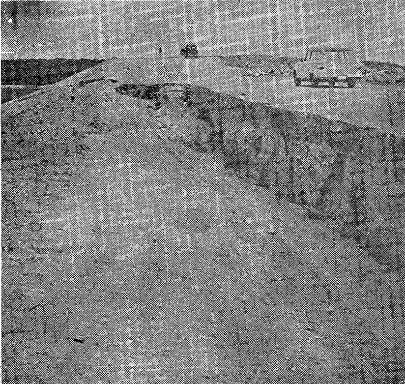
Waco Barajının 1.000 (≈ 332 m) kademlik bir kısmı çöktü ve kaydı
