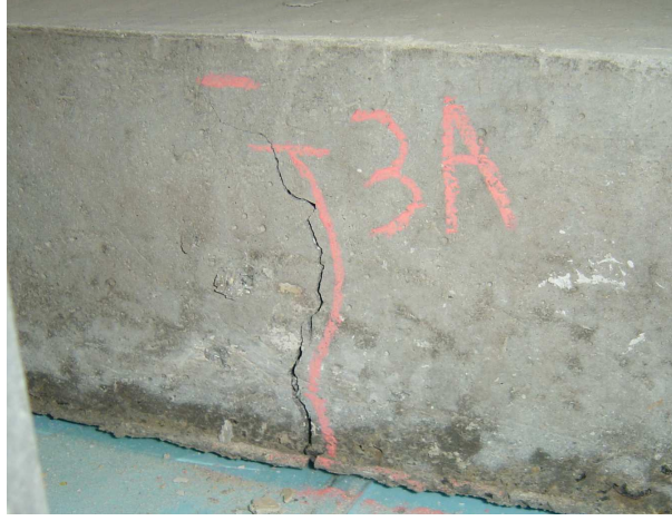
Şekil 7.20 a) P2 plağında X eksenine paralel kenarın ortasında gelişen çatlak [17]
