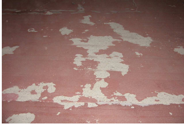
Şekil 8.15 Yüzey sertleştiricide aderans yetersizliği nedeni ile oluşan hasarlar (koyu renkli bölgeler yüzey sertleştirici tabakalar, açık renkli soyulmuş bölgeler ise zemin betonu)
