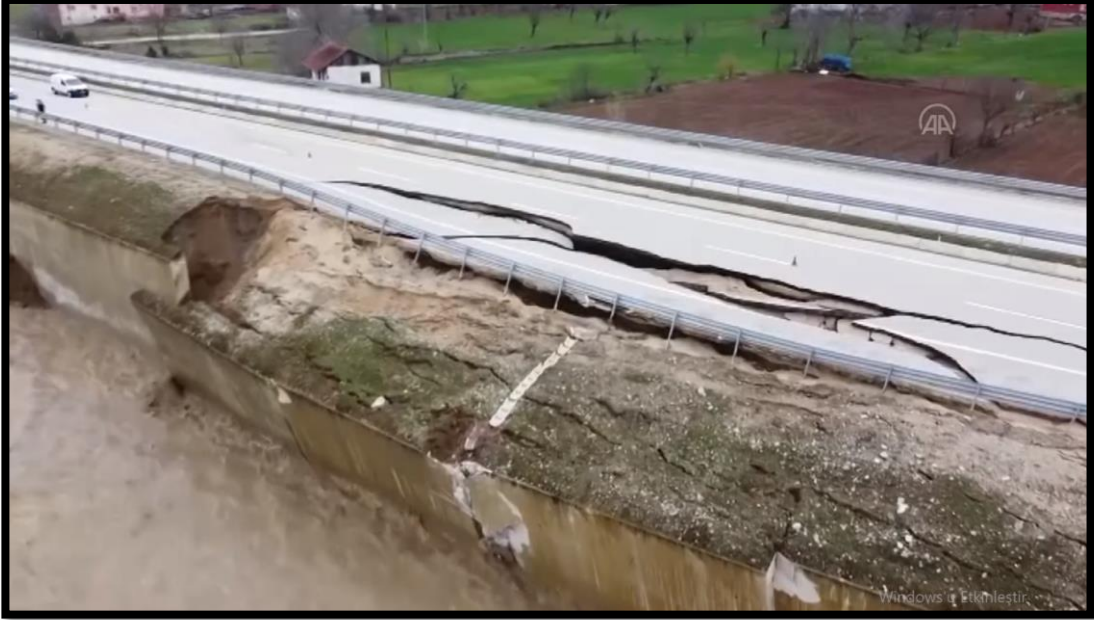
Foto 3. Betonarme Duvar Göçme Durumu
