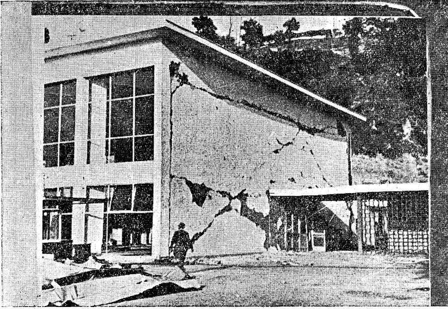
Foto. 27 — Betonarme sistemindeki sergi binasında dolgu duvarların çatlaması.
