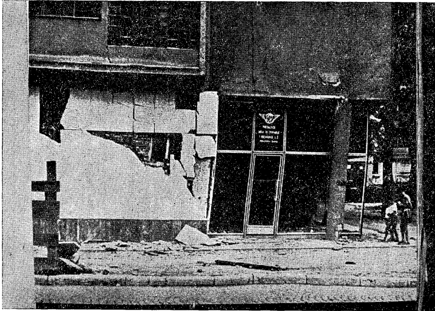
Foto. 20 — Karışık tipte binanın zemin katının maruz kaldığı ağır hasar.
