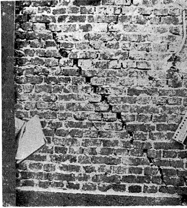
Foto. 17 — Tuğla duvardaki çatlağın yakından görünüşü.
