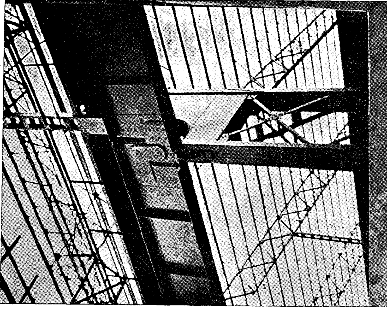
Foto. 36 — Çelik fabrika çerçevesi. Boyuna istikamette, makasları bağtayan basınç elemanları burkulmaya maruz kalmışlardır.
