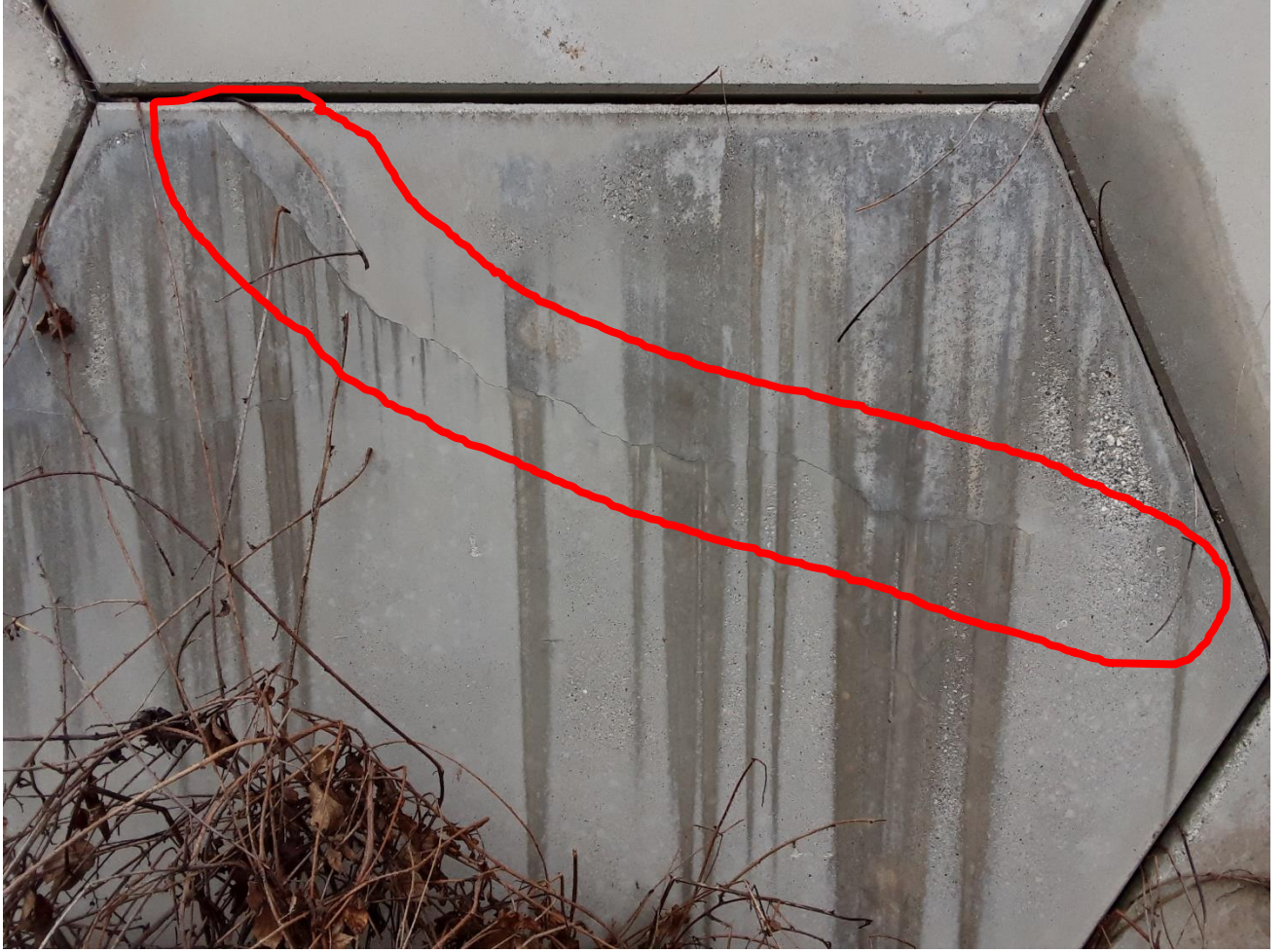
Şekil-10: Prekast cephe elemanında görülen çapraz çatlak
