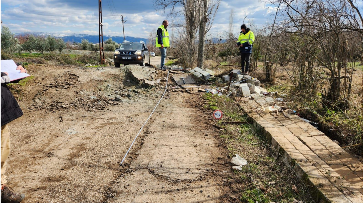
Fotoğraf 6. 06 Şubat 2023 Pazarcık (Kahramanmaraş) depremi sırasında Hassa güneyinde 3 m sol yanal ötelenmiş stabilize yol ve bahçe duvarı.
