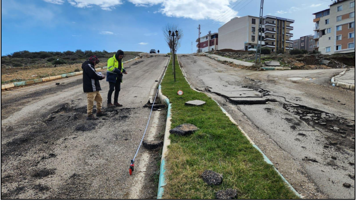
Fotoğraf 1. 06 Şubat 2023 Pazarcık (Kahramanmaraş) depremi sırasında Kırıkhan ilçe merkezinde sol yanal ötelenmiş yol.
