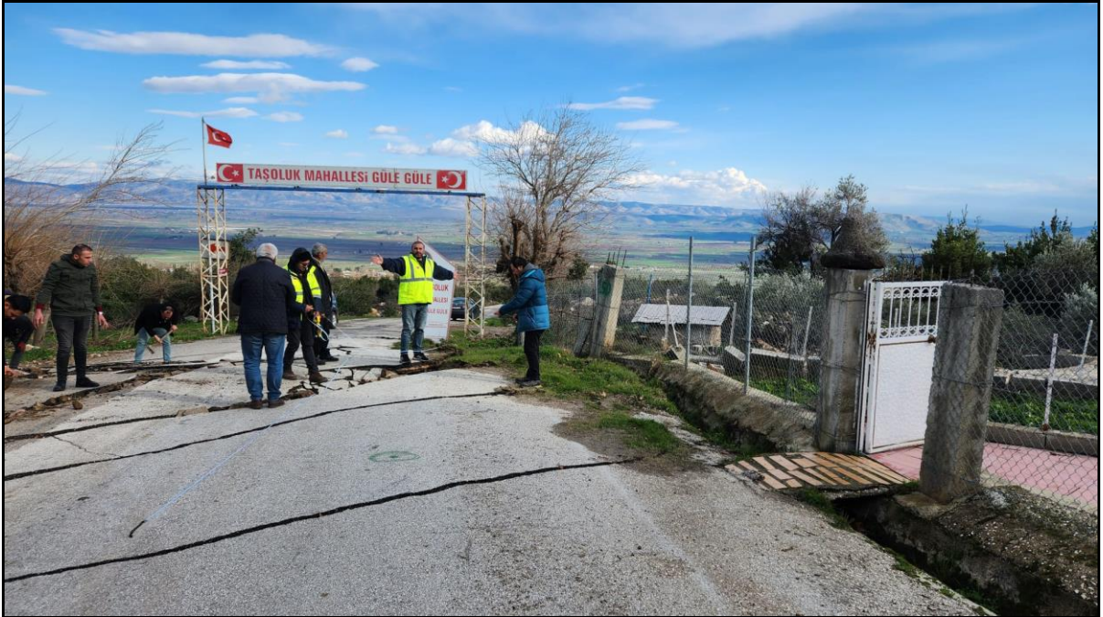
Fotoğraf 4. 06 Şubat 2023 Pazarcık (Kahramanmaraş) depremi sırasında Taşoluk Köyü (Kırıkhan-Hatay) girişinde yolda meydana gelen 2,30 m yer değiştirme.
