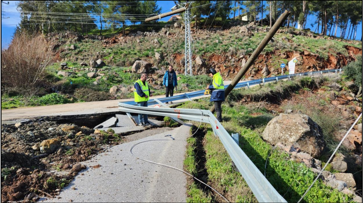
Fotoğraf 2. 06 Şubat 2023 Pazarcık (Kahramanmaraş) depremi sırasında Kırıkhan - Hassa arasında, köy yolunda yüzey kırığı boyunca meydana gelen yaklaşık 2,5 metre sol yanal yer değiştirme.
