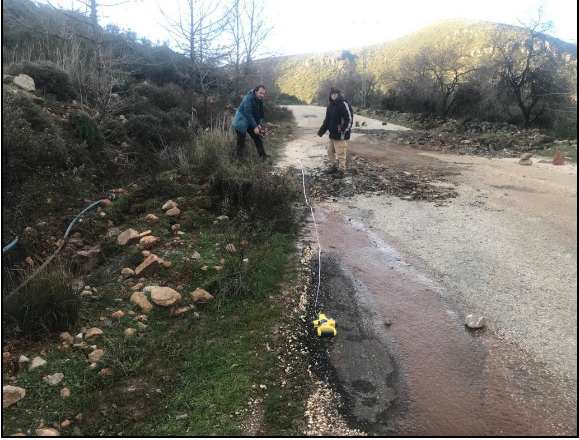
Fotoğraf 3. 06 Şubat 2023 Pazarcık (Kahramanmaraş) depremi sırasında Aktepe Köyü (Hassa-Hatay) KB'sında 80 cm sol yanal ötelenmiş stabilize yol.
