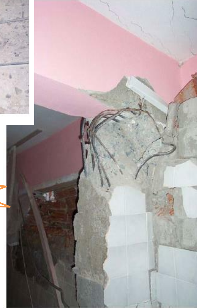
Donatı Kusurları (Kolon-Kiriş bağlantı hataları)
