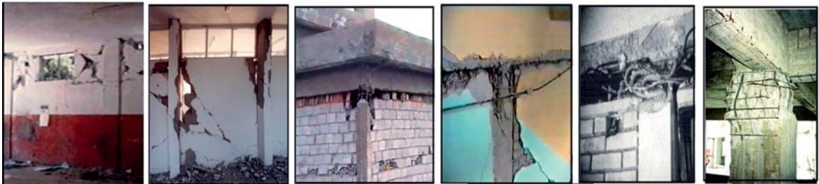
Şekil 17 - Duvar-Kiriş Arasındaki Boşluk Etkisi ile Yatay Deprem Kuvveti Altında Oluşan Yüksek Değerli Kesme Kuvvetlerinin Sebep Olduğu Hasar Biçimi
