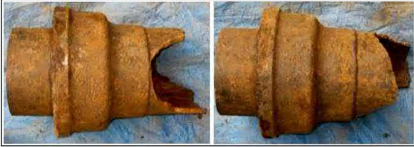
Dökme Demir Boruda Kırılma (temizlendikten sonraki durumu, Black 2013)
