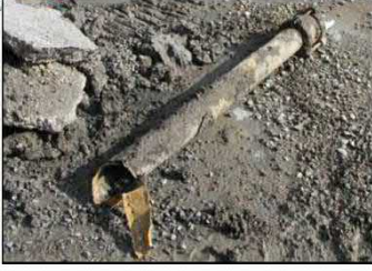
Sarmal Perçinlenmiş Çelik Boru Hasarı
