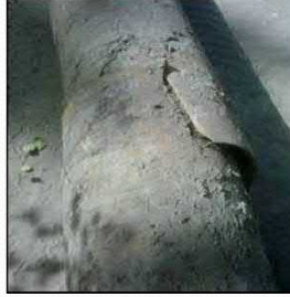
Beton Kaplamalı Çelik Boruda Ayrılma (fotoğraf; P. Free)
