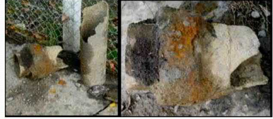
Dökme Demir Boruda Kırılma
