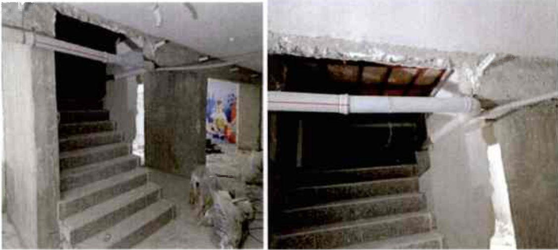
Resim 3: Proje müellifinden, denetim yapan inşaat mühendisinden habersiz/izinsiz kirişleri kesilen, döşemeleri boşaltılan, birkaç yerine merdiven eklenen 19 katlı bina
