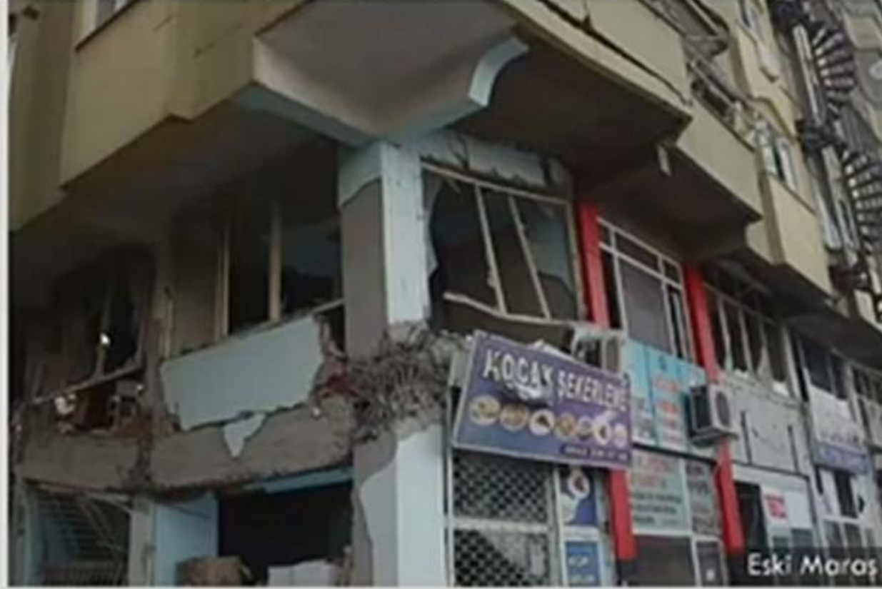
Ağır Hasarlı Bina Betonarme Bina (2000 öncesi)
