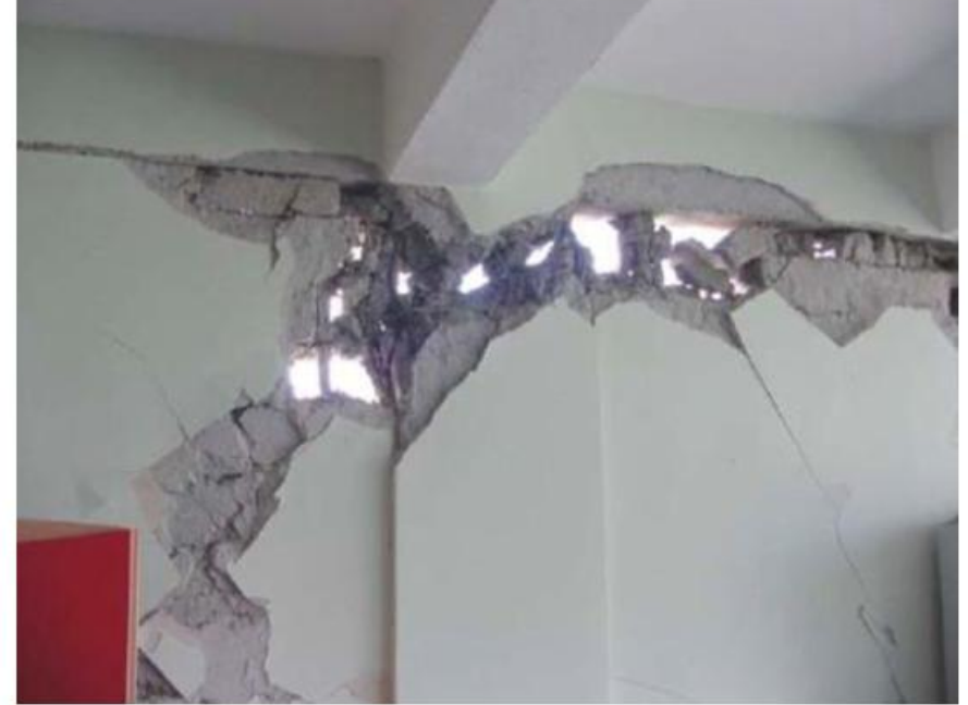
Şekil 1.1. Boşluksuz dolgu duvarların kolonda oluşturduğu kesme hasarı (Özcebe vd., 2004)
