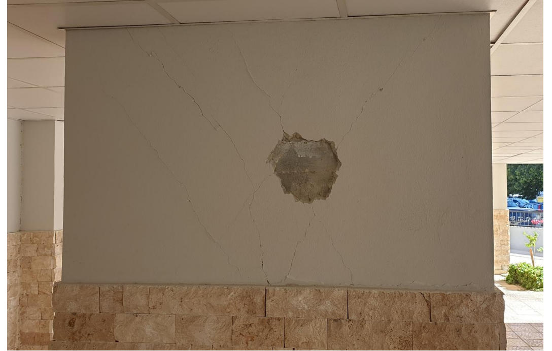
Tipik Kolon Kesme Çatlakları
