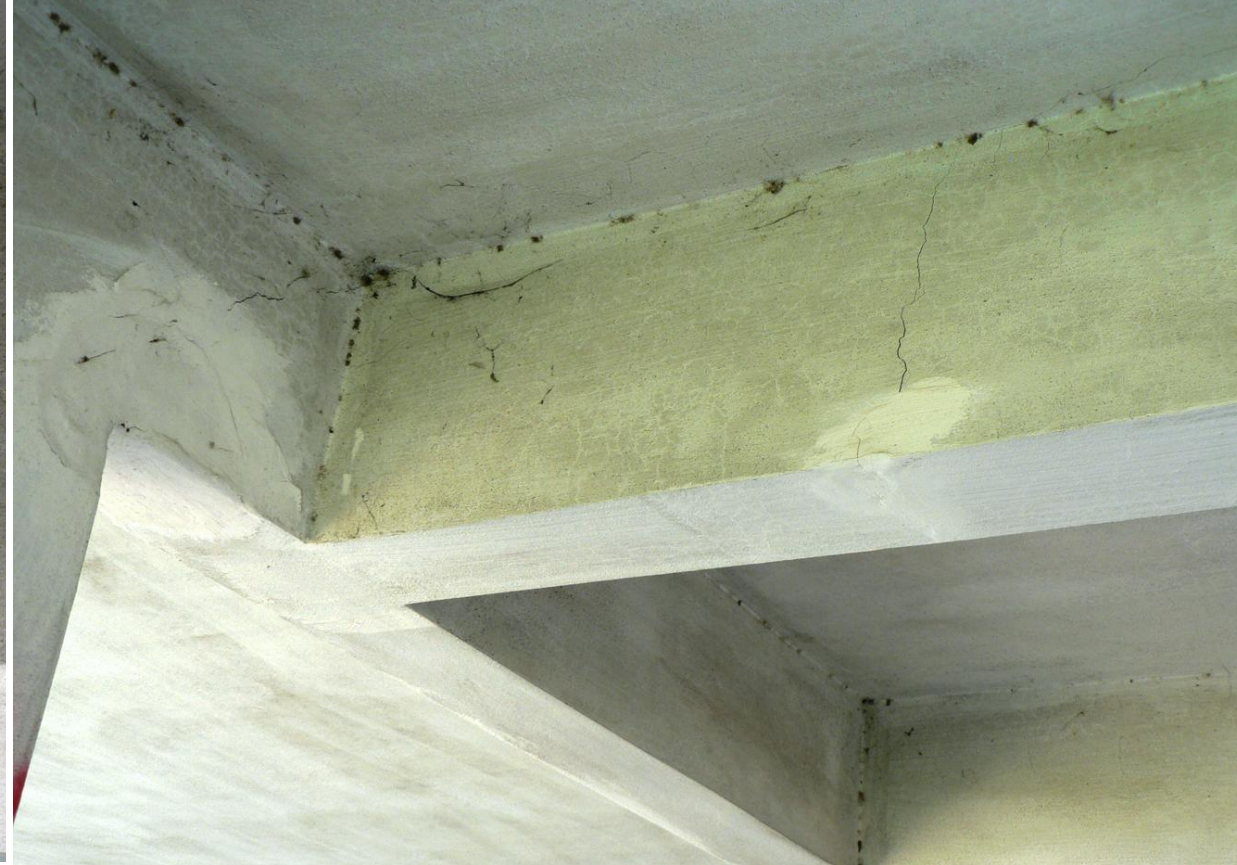
Kiriş Eğilme Hasarı – Kiriş Kesme Hasarı
