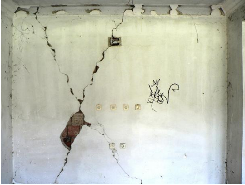
Tipik Duvar Kesme Çatlakları
