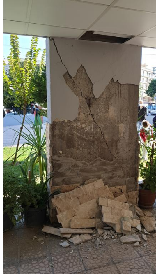
Tipik Kolon Kesme Çatlakları
