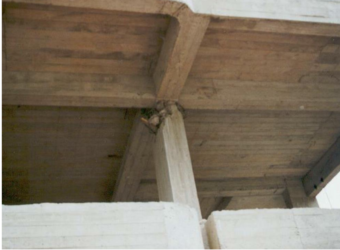
Tipik Kolon Eğilme Hasar Mekanizması
