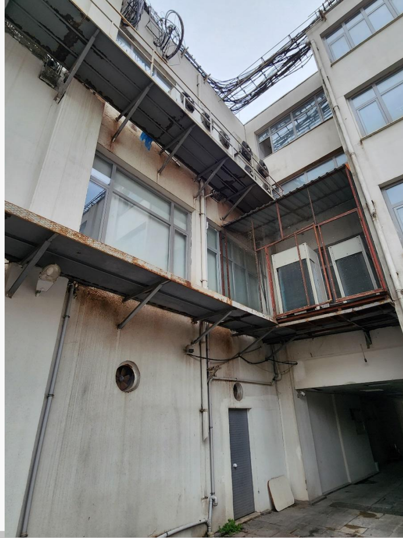
Güçlendirilmiş Yapı – Deprem Sonrası
