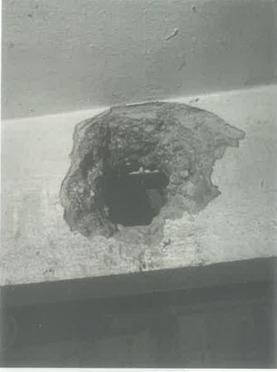
Fotoğraf 5. Betonarme kirişte tesisat için açılan boşluk ile verilen hasar
