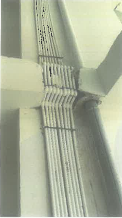
Fotoğraf 7. Betonarme kirişte tesisat geçişleri ile verilen hasar
