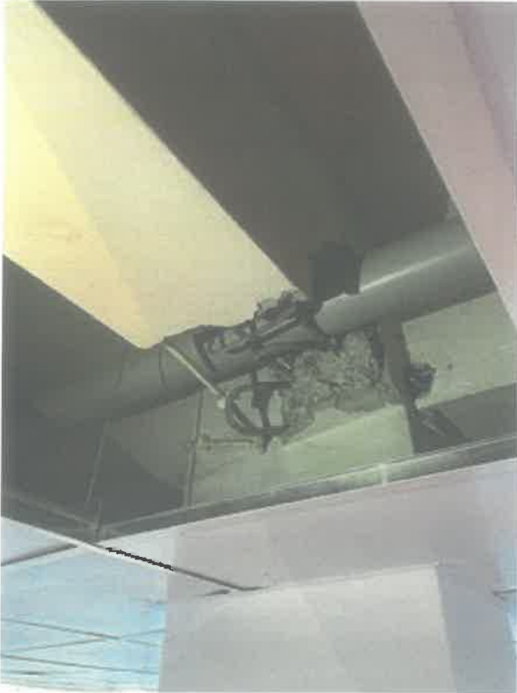
Fotoğraf 8. Betonarme kirişte tesisat geçişi ile verilen hasar
