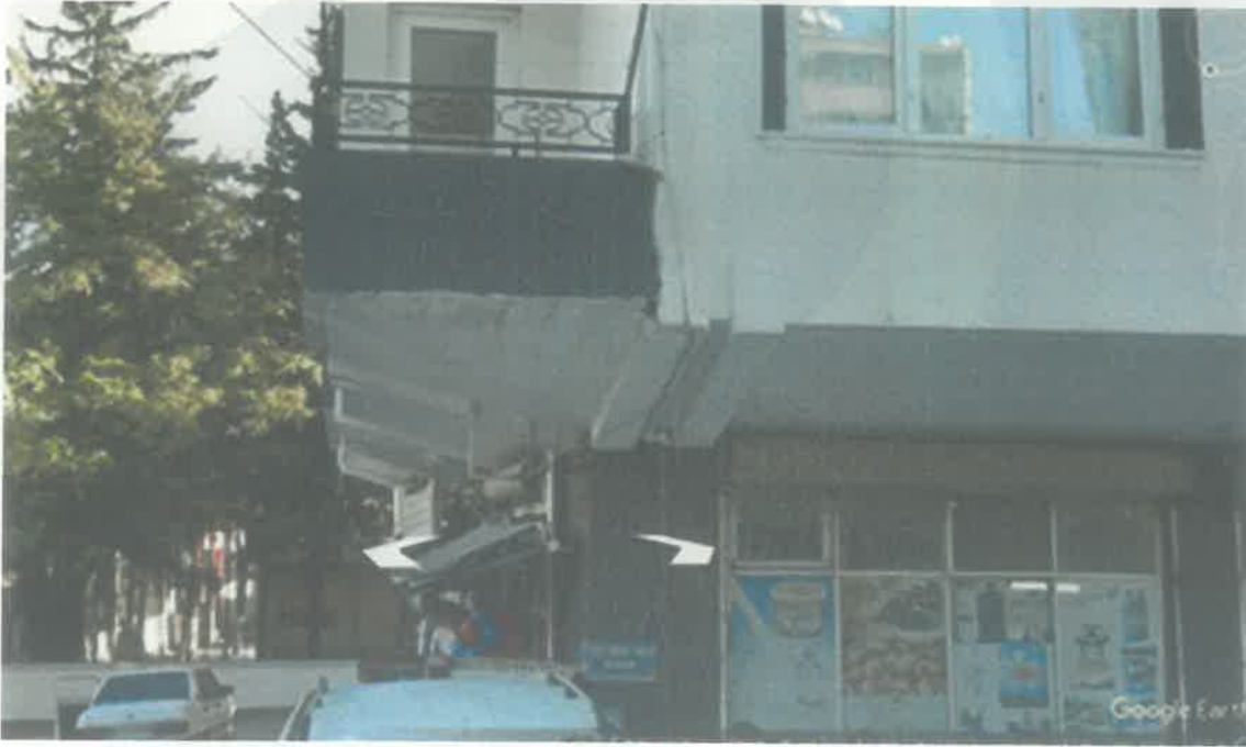
Fotoğraf 1. Kapalı çıkmada konsol ve alın kirişlerinin yapılmadığı (veya kaldırıldığı), zemin kattaki tüm duvarların market tarafından kaldırıldığı bina örneği.
