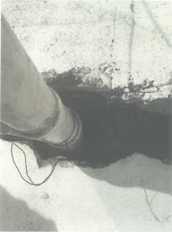
Fotoğraf 3. Betonarme kirişte boru geçişi ile verilen hasar
