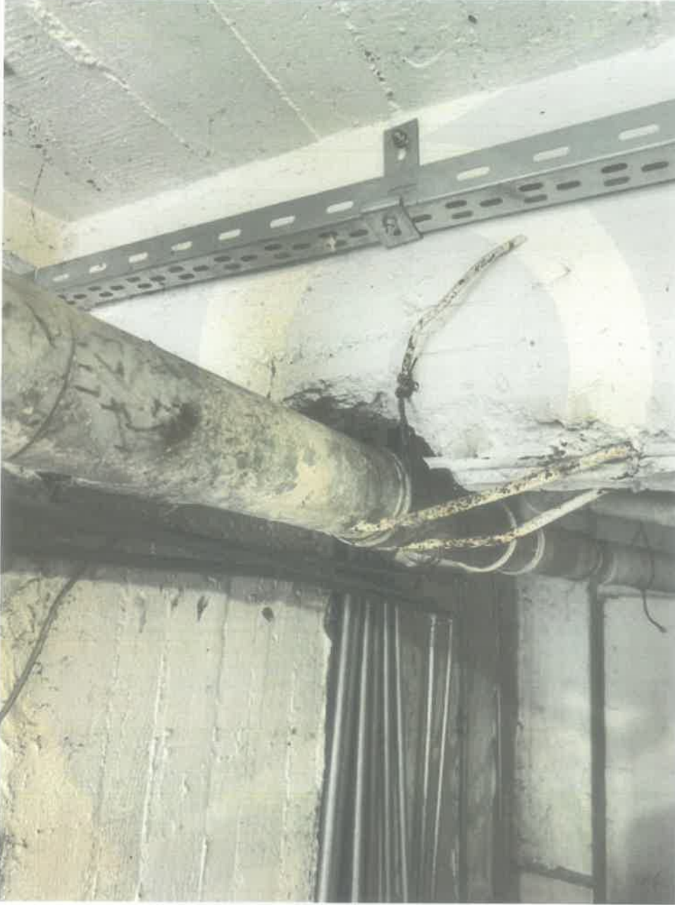
Fotoğraf 4. Betonarme kiriş gövdesinde boru geçişi için kirişe ve donatıya verilen hasar
