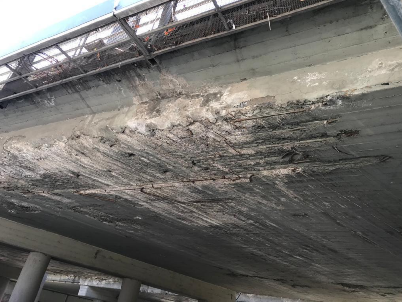
Döşemelerde Donatının Açığa Çıkması ve Korozyona Uğraması
