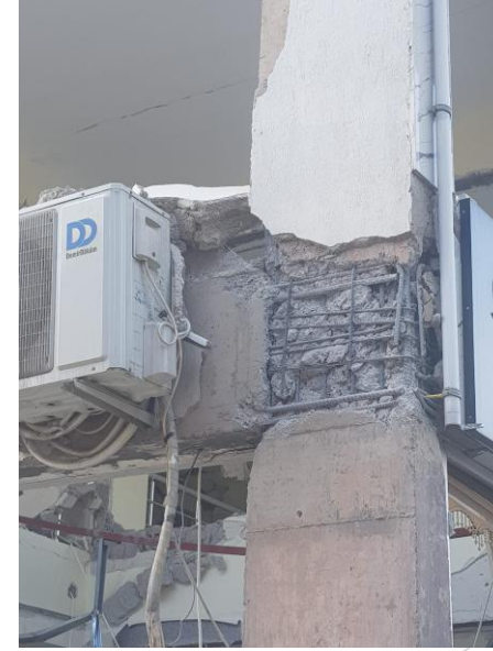
Kolon-Kiriş bölgesi Hasarı, 6 Şubat depremi, Hatay
