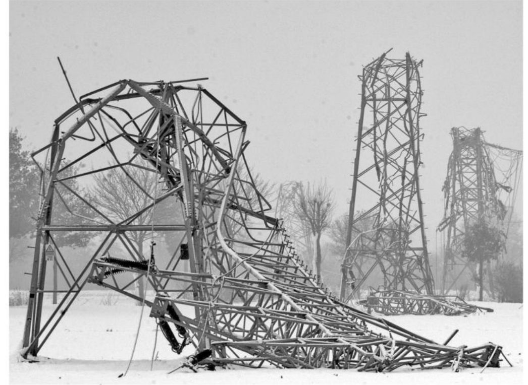
Enerji nakil hattının kar birikmesi nedeniyle göçmesi (Münsterland, Germany, 2005)
