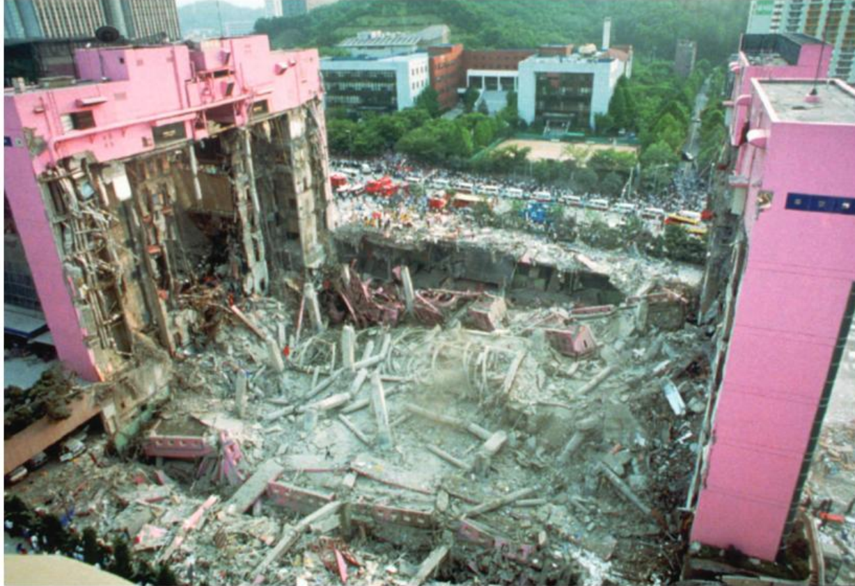
Sampoong Superstore, çatı döşemesinin zımbalaması (Seoul, South Korea, 1995)
