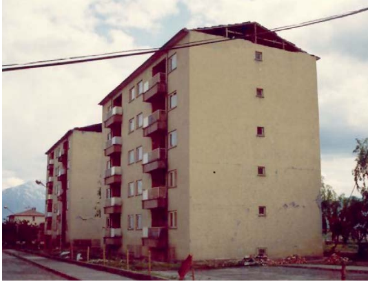
Resim 1 - Erzincan Depreminden Sonra Silahlı Kuvvetler Lojmanları
