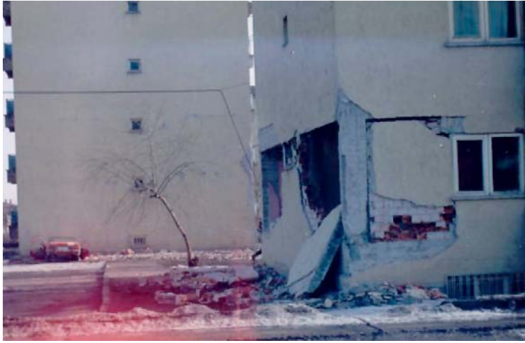
Resim 2 - Yapım Hatasının Sebep Olduğu Hasar
