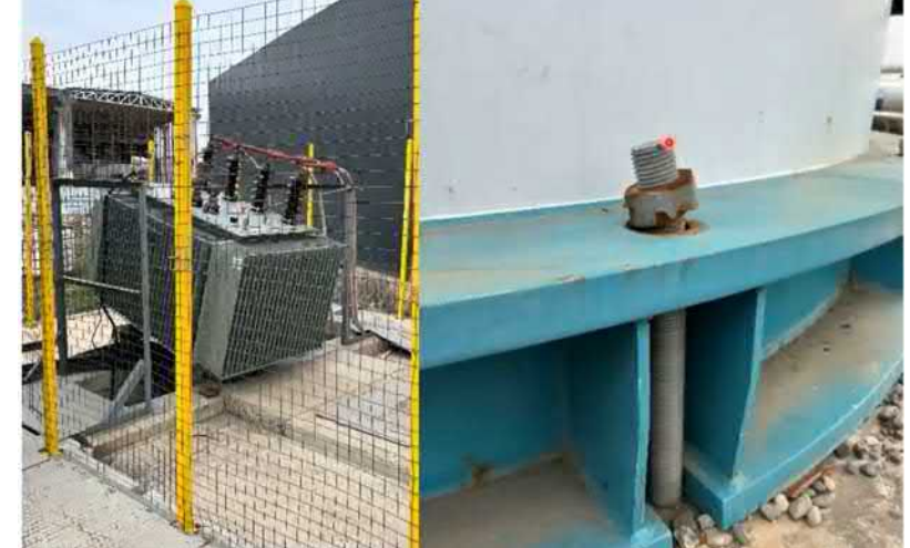
Deforme olmuş ankrajlar ve hasarlı jeneratör
