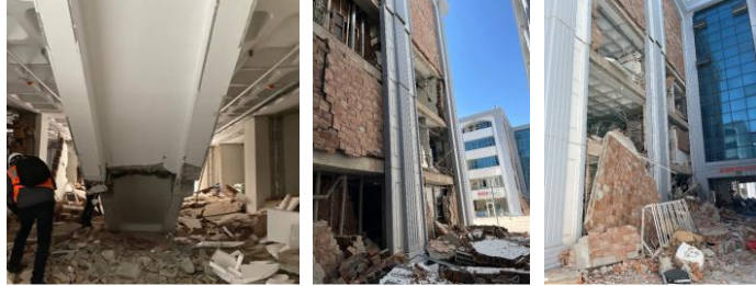
Bloklar arasında dış merdiven sistemi ve yaygın yığma bölme duvarı hasarları
