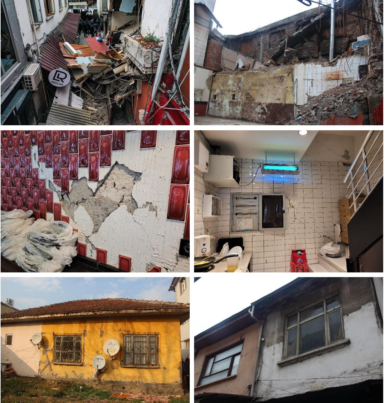
Şekil 12: Yığma binalarda yapısal hasar örnekleri
