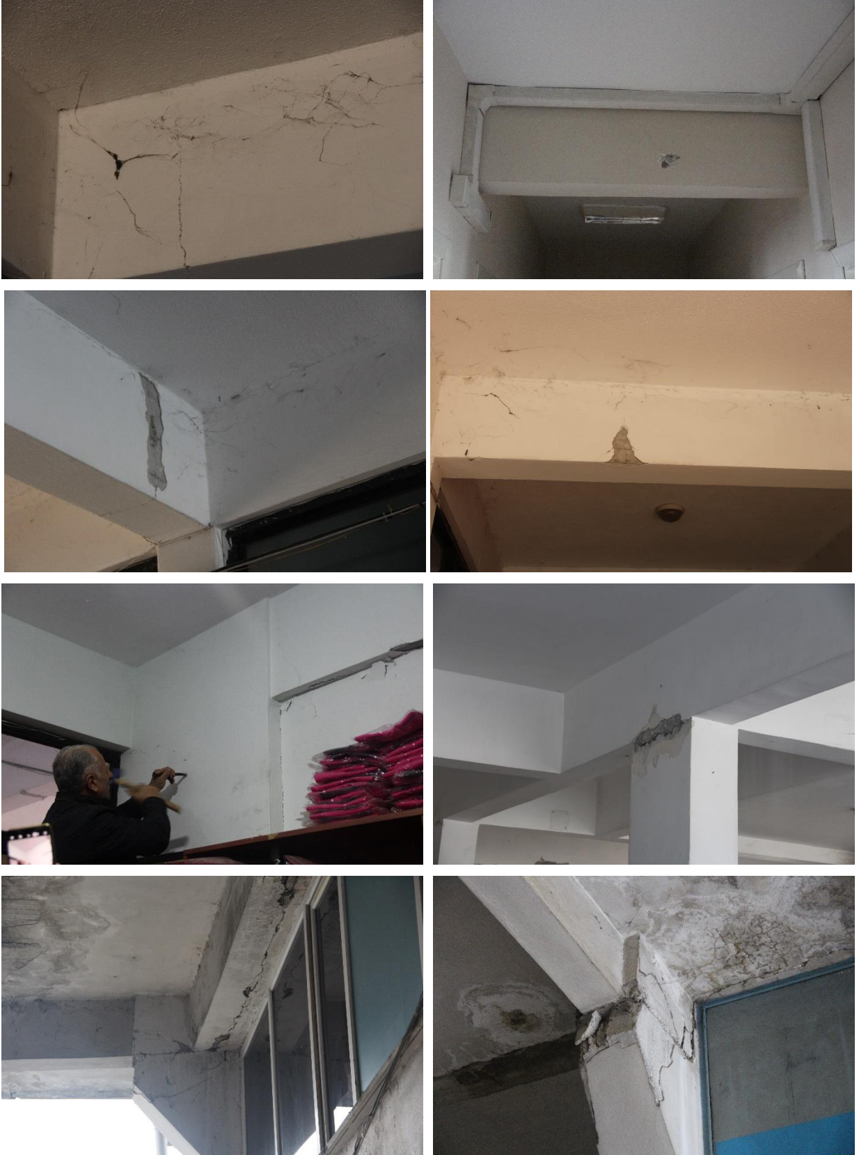
Şekil 11: Betonarme binalarda yapısal hasar örnekleri
