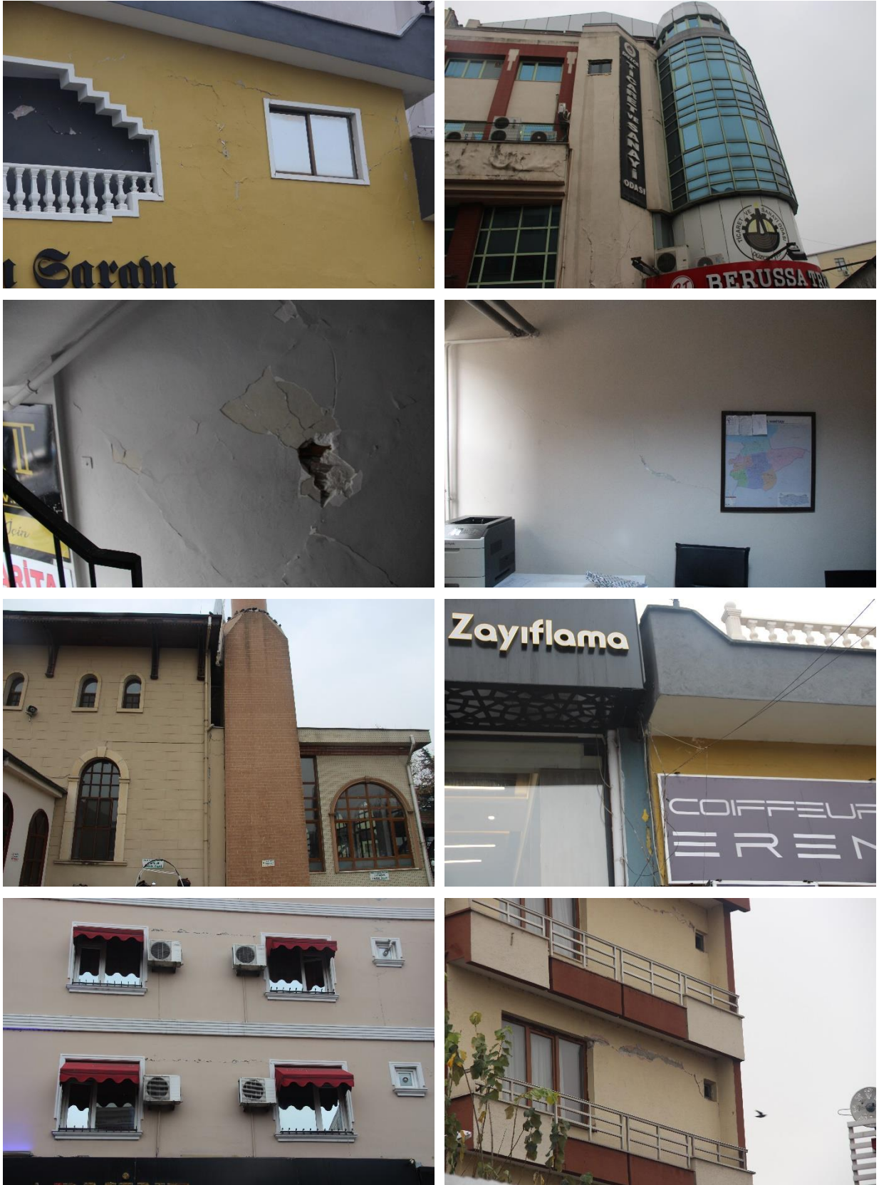
Şekil 10: Betonarme binalarda yapısal olmayan hasar örnekleri
