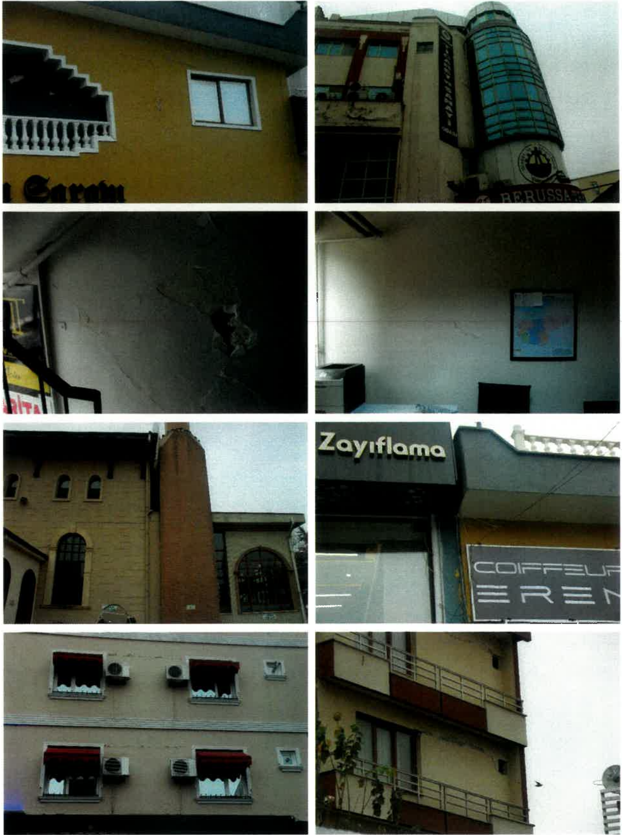
Şekil 10: Betonarme binalarda yapısal olmayan hasar örnekleri
