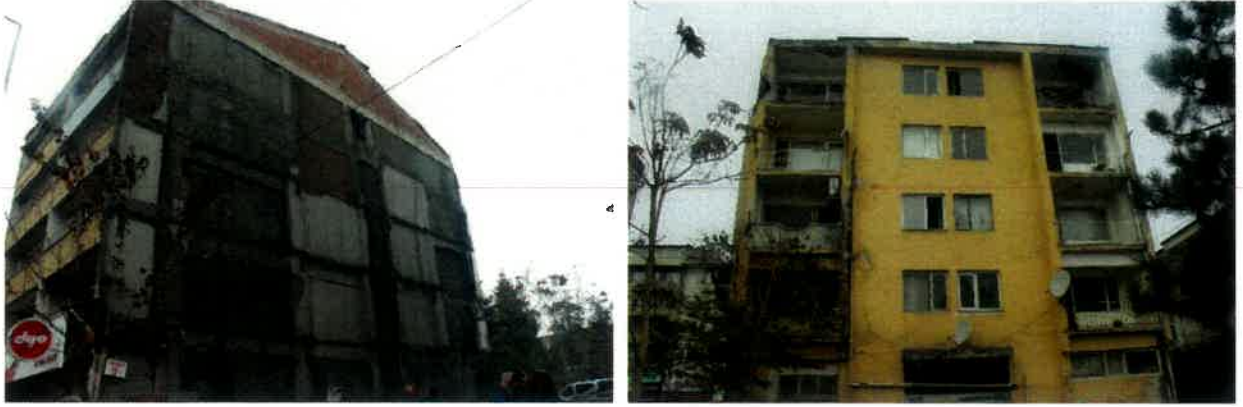
Şekil 14: Güçlendirilmiş binaların Gölyaka depremi sonrası durumları
