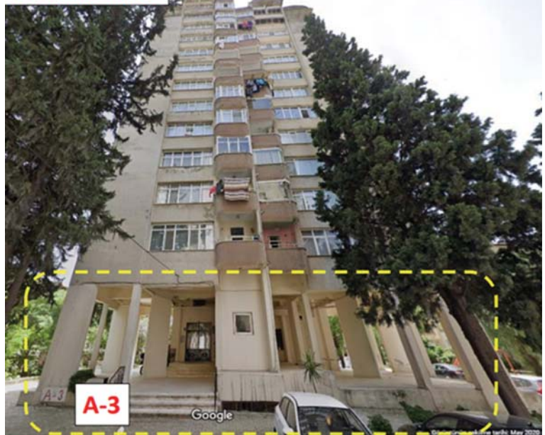
Fotoğraf 17 - Zemin katı duvarsız bu blok tümü ile yıkılmıştır.
