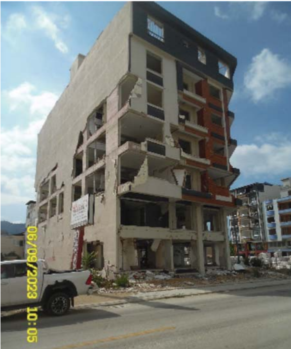
Fotoğraf 14 - Taşıyıcı sisteminde hasar olmayan ancak dolgu duvarları yıkılmış bir başka betonarme yapı (Antakya 6 Şubat 2023 Depremi)
