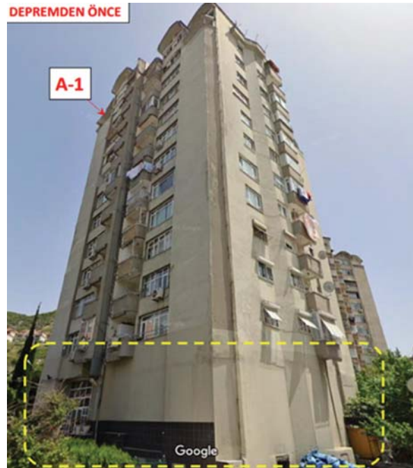
Fotoğraf 15 - zemin katındaki boşluklar dolgu ve bölme duvarı ile örülmüş
