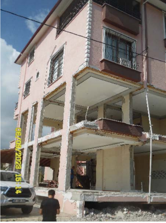
Fotoğraf 13 - Taşıyıcı sisteminde hasar olmayan ancak dolgu duvarları yıkılmış betonarme yapı (Antakya 6 Şubat 2023 Depremi)
