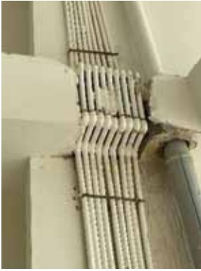
Fotoğraf 7 - Betonarme kirişte tesisat geçişleri ile verilen hasar
