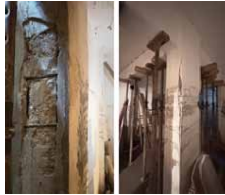
Fotoğraf 11 - Betonarme kolonlarda ve döşemede korozyon hasarı örnekleri
