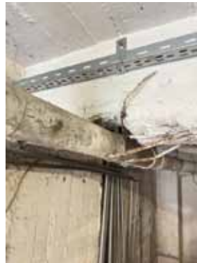
Fotoğraf 4 - Betonarme kiriş gövdesinde boru geçişi için kirişe ve donatıya verilen hasar
