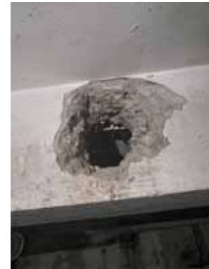
Fotoğraf 5 - Betonarme kirişte tesisat için açılan boşluk ile verilen hasar
