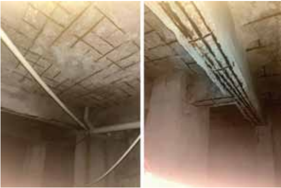
Fotoğraf 10 - Betonarme kiriş ve döşemede korozyon hasarı örnekleri
