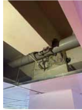
Fotoğraf 9 - Betonarme kolonda tesisat geçişi ile verilen hasar
