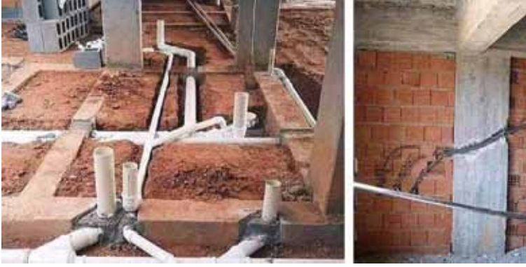
Fotoğraf 6 - Temelde ve kolonda tesisat geçişleri ile verilen hasar
