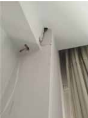
Fotoğraf 2 - Kolon ve kirişte tesisat geçişi ile verilen hasar
