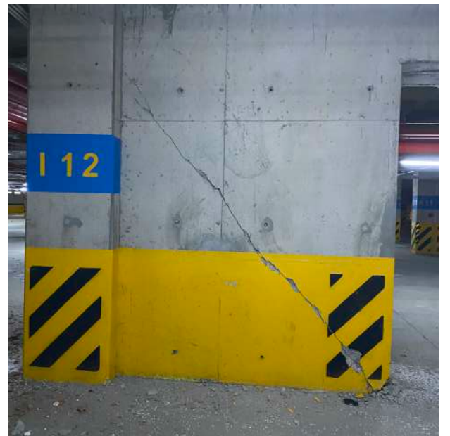
Foto 2: Kuyumcukent'te zemin katta dış merdiven sistemi hasarı ve yaygın yığma bölme duvarı hasarları ve bodrum katta bir perdede kesme hasarı
