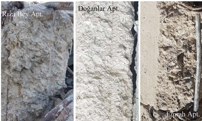
Şekil 14 - Yıkılan bazı binalarda gözlenen beton kalitesi
