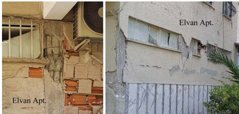
Şekil 28 - Kısa kolon oluşumu nedeni ile ağır hasar almış bir bina
