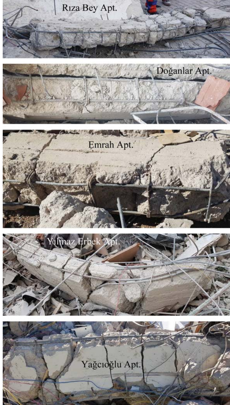
Şekil 18 - Yıkılan bazı binaların kolon ve kirişlerindeki donatı düzenlemesi
