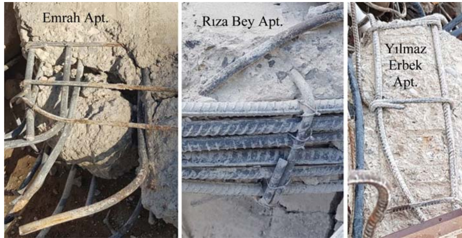
Şekil 16 - Yıkılan bazı binalara ait donatı detayları
