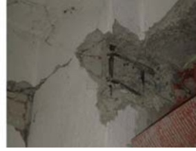
C tipi hasar Çatlak genişliği > 3 mm, Belirgin kabuk dökülmesi, çok hafif donatı burkulması
