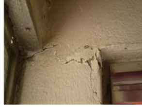
B tipi hasar Çatlak genişliği 0.5 mm ile 3 mm arasında, kabuk betonu ezilmesi
