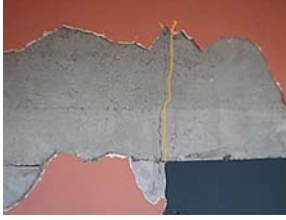
A tipi hasar Çatlak genişliği < 0.5 mm
