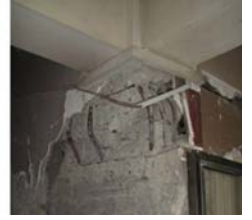
D tipi hasar Donatı burkulması, çekirdek betonu ezilmesi ve kalıcı deformasyon
