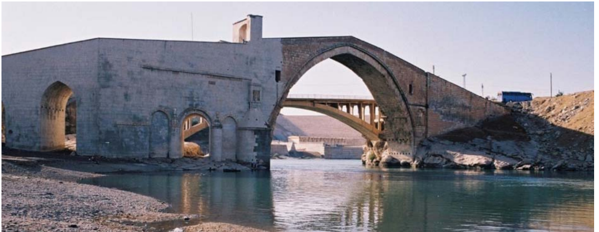
Şekil 8 - 1985 Yılında Köprü Yüzeylerine Taş Tozu Katkılı Çimento Esaslı Harç İle Yapılmış Müdahale, 2009
