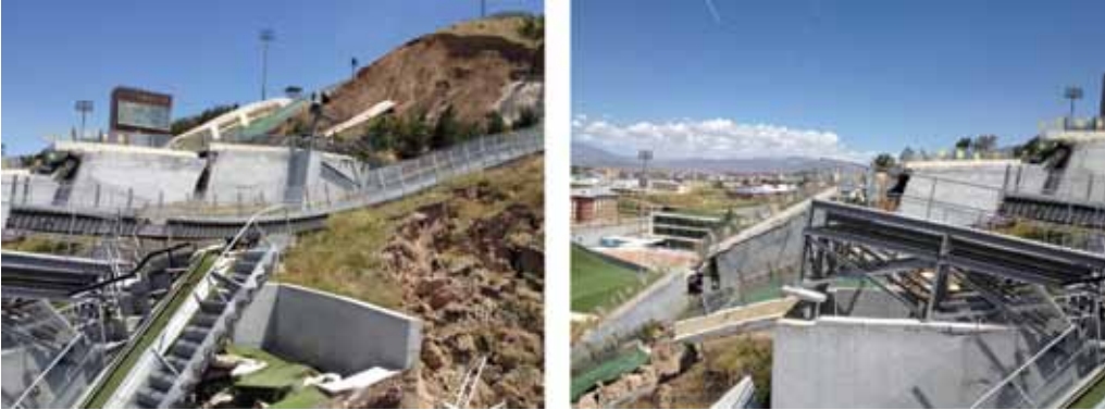
Şekil 3 - İniş rampalarında meydana gelen yapısal hasarlara örnekler
