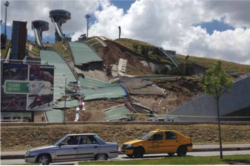
Şekil 2 - Heyelan sonrası iniş rampalarındaki hasar
