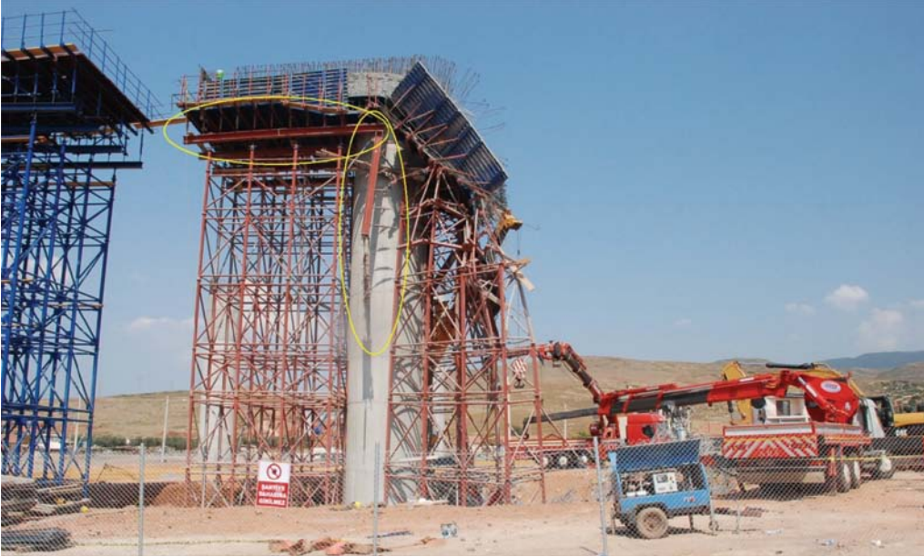
Resim 3 - İskelesinin çöken kısmına ait aşağı sarkık asılı kalan Çelik taşıyıcı putreller
