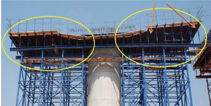
Resim 2A - Çöken Viyadük ayağının yanındaki iskelesi tamamlanmış kalıp imalatı yapılan ayak - En uçta yükseklik ayarı sonuna kadar açılmış, aralarında her iki yönde yatay ve diyagonal bağlantı kullanılmamış dikmeler
