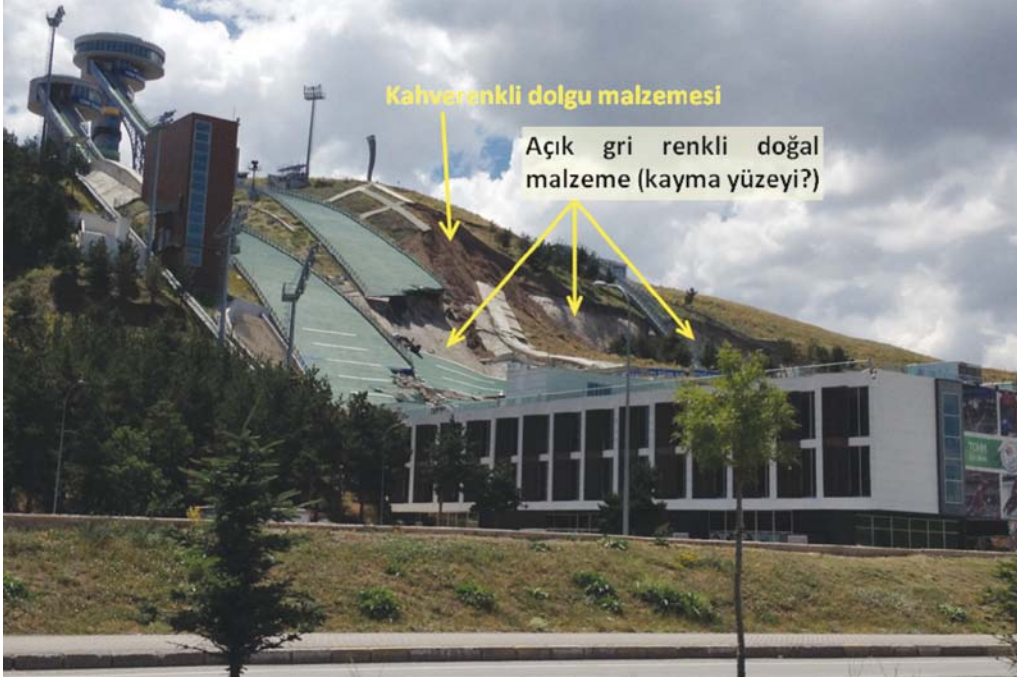
Şekil 4 - Heyelanda kahverengi dolgu malzemesi ve açık gri renkli doğal malzeme
