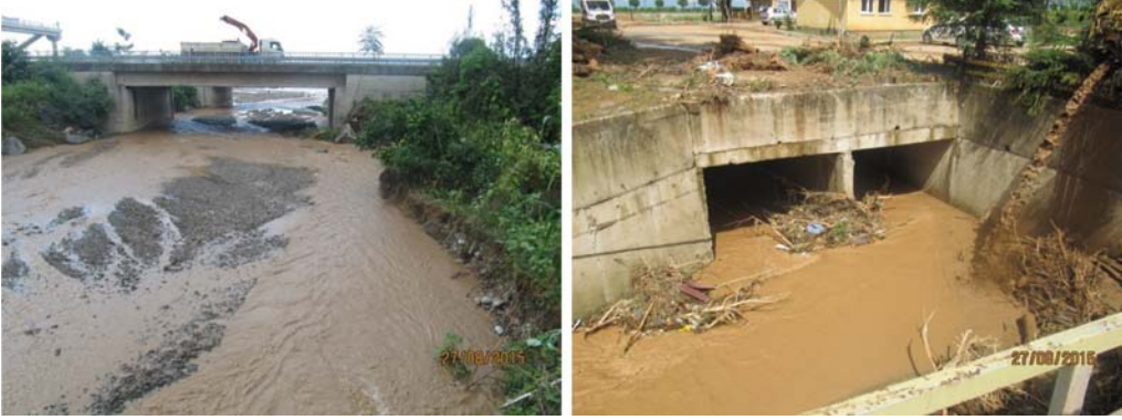
Şekil 11 - Köprü ve Menfezlerin Tıkanması
