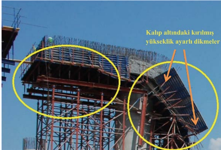
Resim 1A - Çöken Viyadük ayağı – Kalıp altında kırılmış yükseklik ayarlı dikmeler
