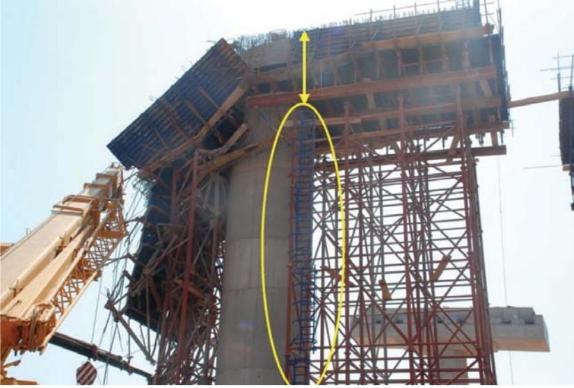
Resim 7 - Çalışma platformuna tehlikeli ve yetersiz ulaşım merdiveni
