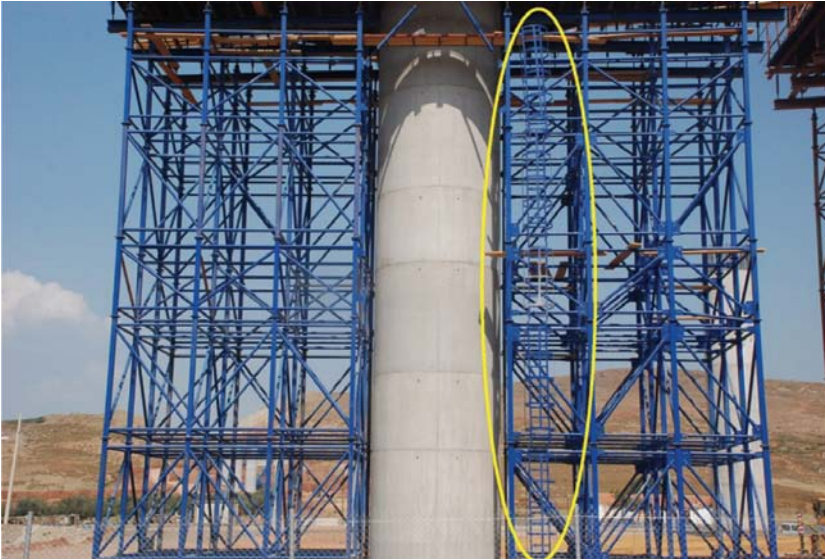
Resim 7A - Bitişik viyadük ayağındaki kalıp platformuna tehlikeli ve yetersiz ulaşım merdiveni
