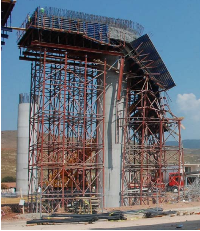
Resim 1 - Çöken Viyadük ayağı
