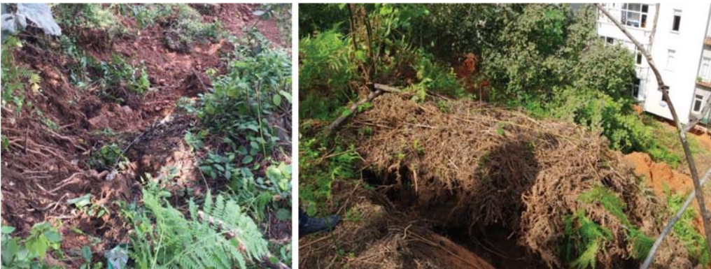
Şekil 6 - Arhavi İlçesi Atatürk Bulvarı Musazade Mahallesi'nde Oluşan Çekme Çatlakları
