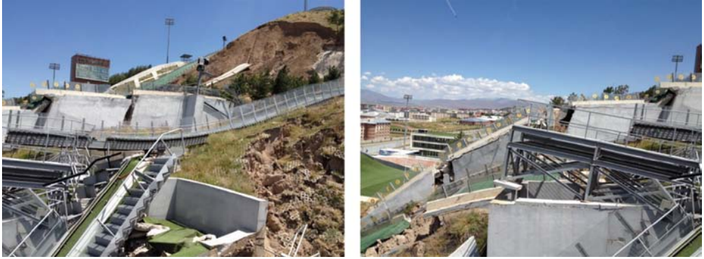
Şekil 3 - İniş rampalarında meydana gelen yapısal hasarlara örnekler
