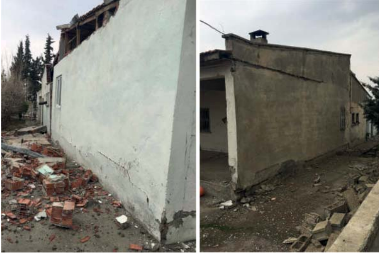
Şekil 21 - Çatı kalkan duvarı devrilmeleri
