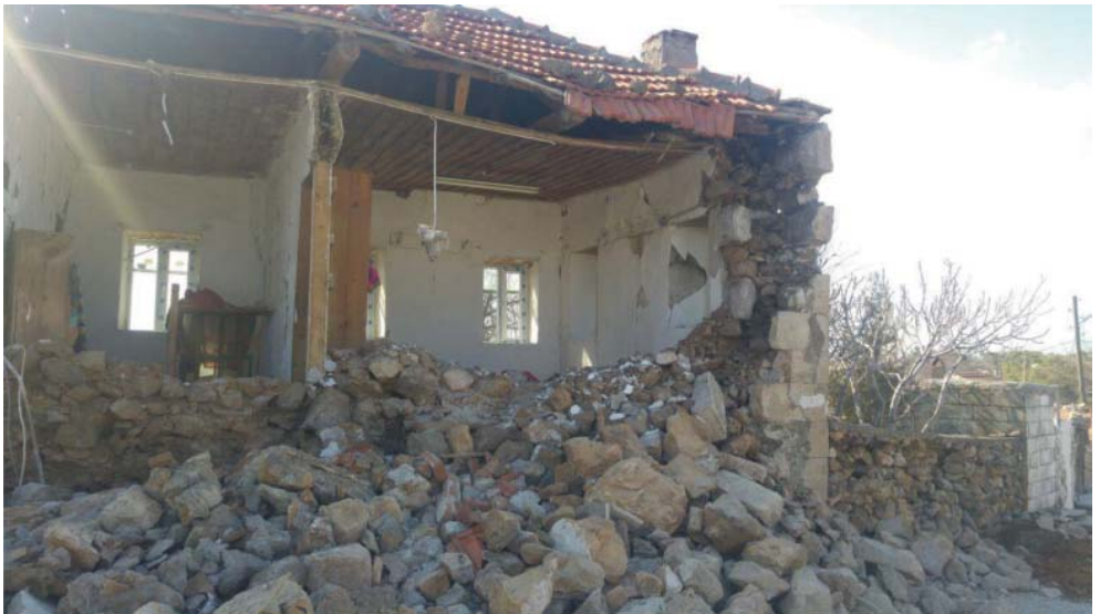
Fotoğraf 4 - Bölgedeki genel hasar gören yapı kesiti
