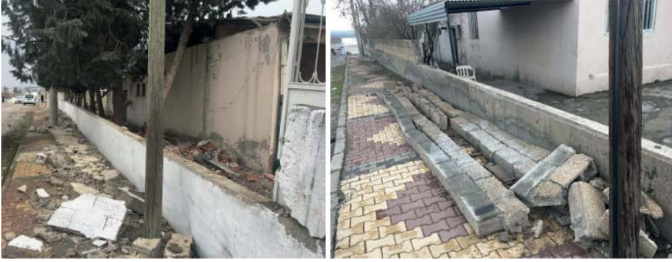
Şekil 20 - Bahçe duvarı devrilmeleri
