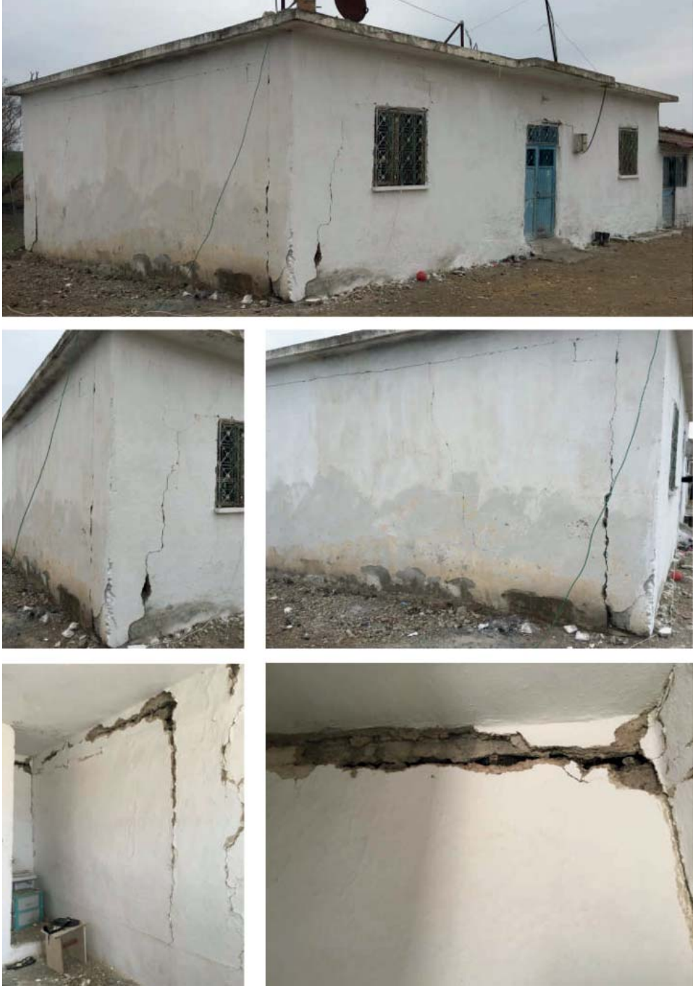
Şekil 15 - Çiçek köyündeki geleneksel yığma yapı hasarları
