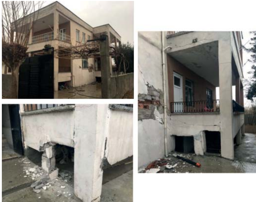
Şekil 8 - Samsat İlçe merkezindeki iki katlı konut yapısındaki yapısal hasar
