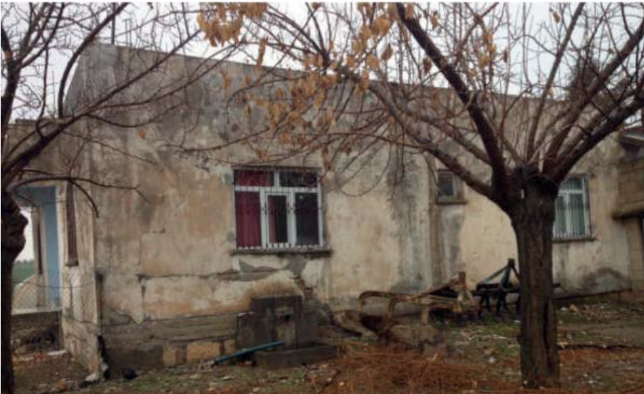
Şekil 16 - Örentaş köyündeki yapı hasarları
