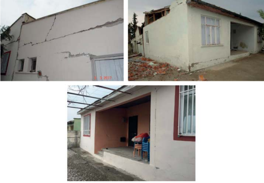
Şekil 14 - Konutları Atatürk Barajı gölet alanı içinde kalan aileler için yapılan tipik konut yapılarındaki yapısal olmayan hasarlar
