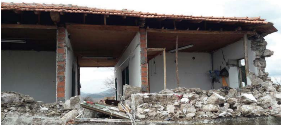
Fotoğraf 2 - Taş duvarlarda hasar bağlayıcı harç kullanılan duvarlar ayakta
