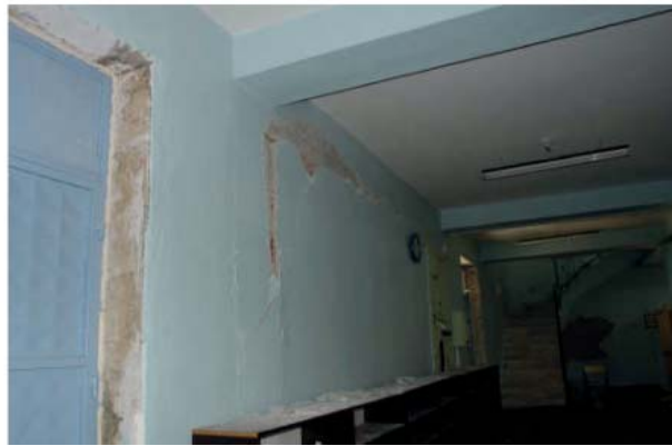
Şekil 13 - Hacı Ömer Camisi'ndeki yapısal olmayan hasarlar
