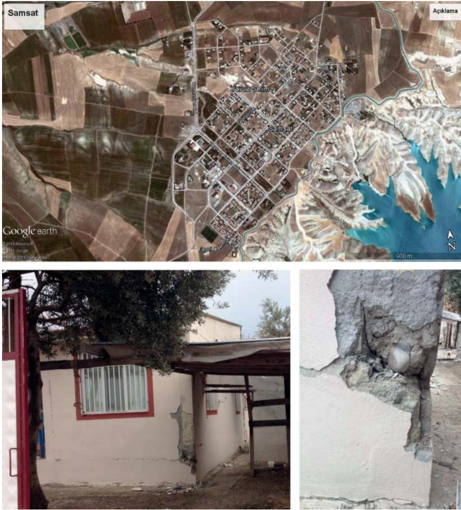
Şekil 9 - Konutları Atatürk Barajı gölet alanı içinde kalan aileler için yapılan tipik konutların yerleşimi ve bu yapılardaki yapısal hasarlar
