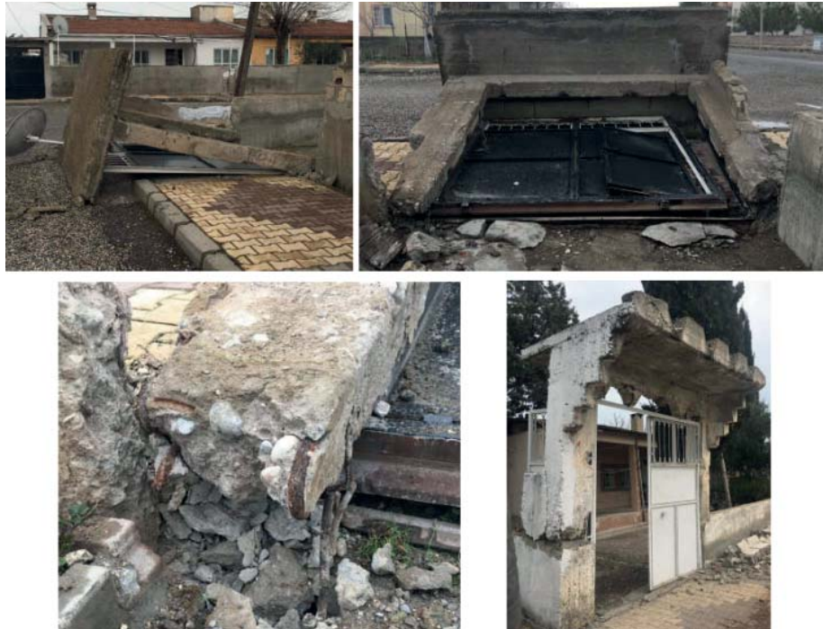
Şekil 19 - Tek katlı tipik konut yapılarının bahçe kapılarındaki hasarlar
