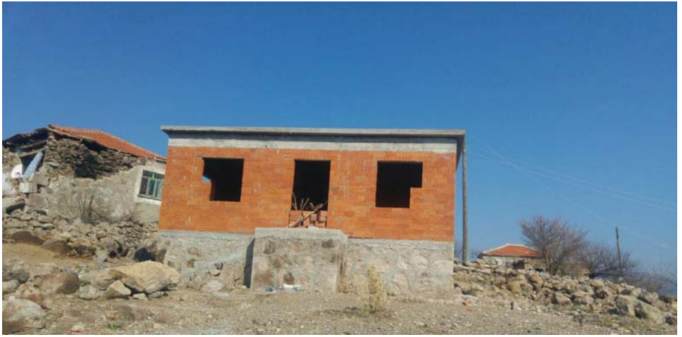
Fotoğraf 3 - Önde sağlam arkada ise ocak kullanımından dolayı hasar görmüş yapı
