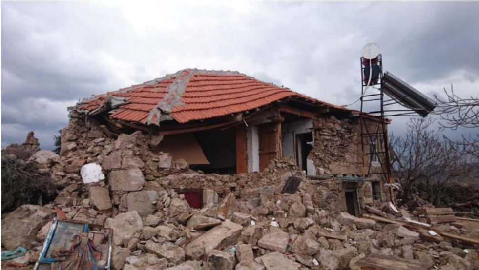
Fotoğraf 1 - Çamur ve taştan yapılmış yapıda köşeden yıkılma hasarı
