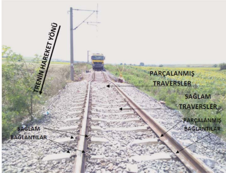
Resim 8 - Menfezi geçtikten sonra trenin hareket yönünde sağlam kalan traversler ve ray-travers bağlantı elemanlarının durumu. Trenin hareket yönündeki sol rayın hattın dışına doğru eğildiği (şekil değiştirdiği) görülmektedir.
