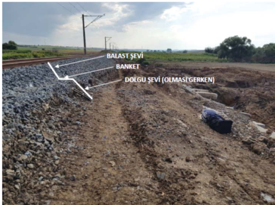
Resim 17 - Onarılan demiryolu hattının dolgu bölümünde ölçülerine uygun yapılmamış dolgu eğik yüzeyi (şevi).
