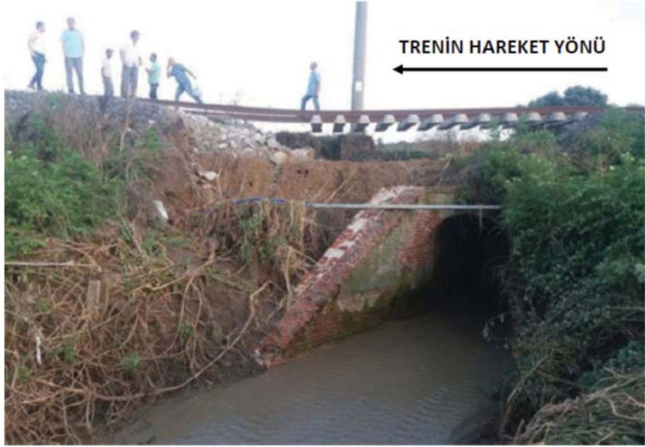
Resim 2 - Menfezin üstündeki toprak dolgu ve balast tabakası boşalmış, travers ve raylardan oluşan yol çerçevesi boşa (askıda) kalmış, beton traverslerin bir kısmı trenin geçişi sırasında zarar görmüştür.
