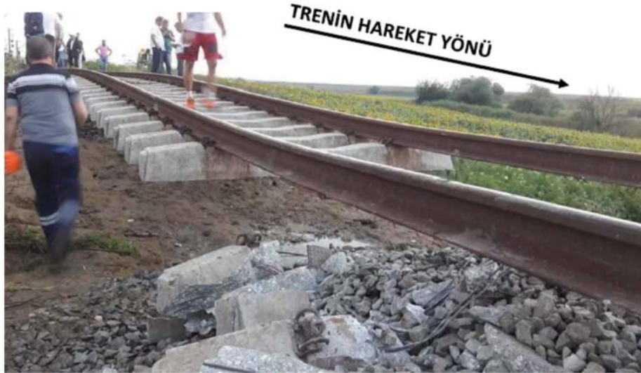
Resim 3 - Trenin hareket yönünde menfezden hemen sonra rayların altındaki traverslerin bir kısmı ezilip parçalanmış ve rayların altındaki boşluğa yığılmıştır.
