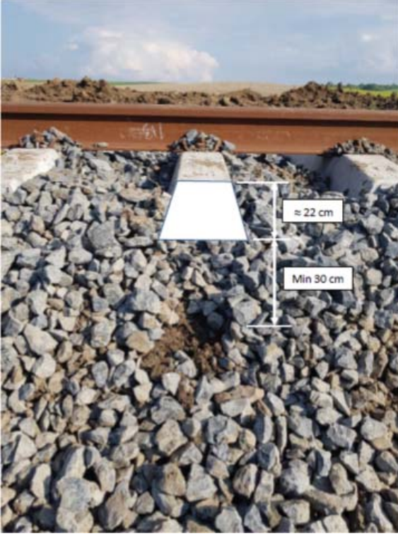
Resim 18 - Onarılan hat kesiminde balast tabakasının kalınlığı yeterli değil. Balast malzemesi zemin ile karışmış.
