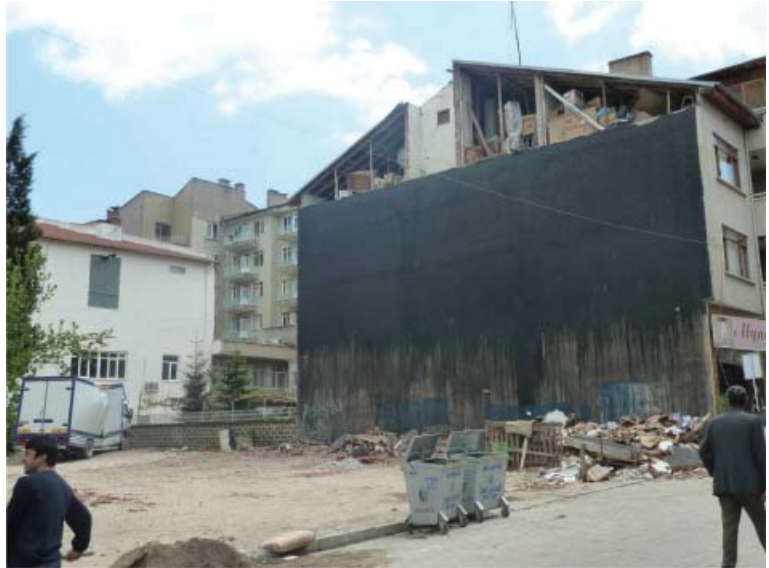
Kalkan duvar hasarı
