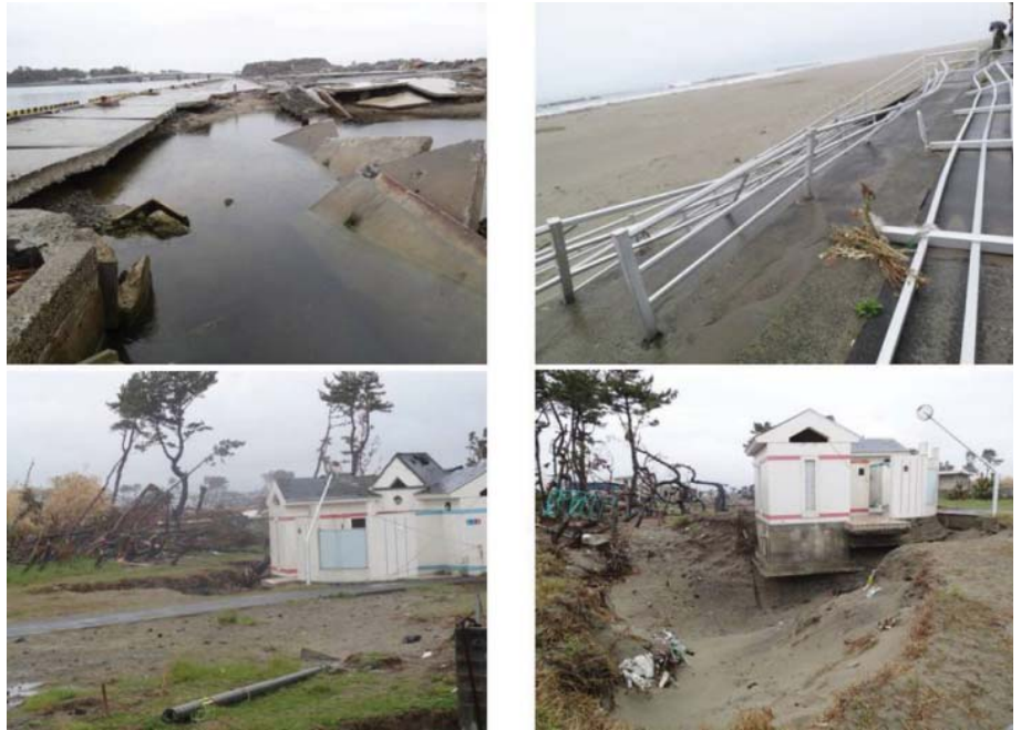
Şekil 1 - Sendai Bölgesi Arabama kasabasında rıhtım dolgusunun sivilaşma etkisi ile çökmesi (sol üst), kıyı koruma duvarı (sağ üst), Yapı çeresinde güçlü akıntılar nedeniyle oyulmalar (sol ve sağ alt)
