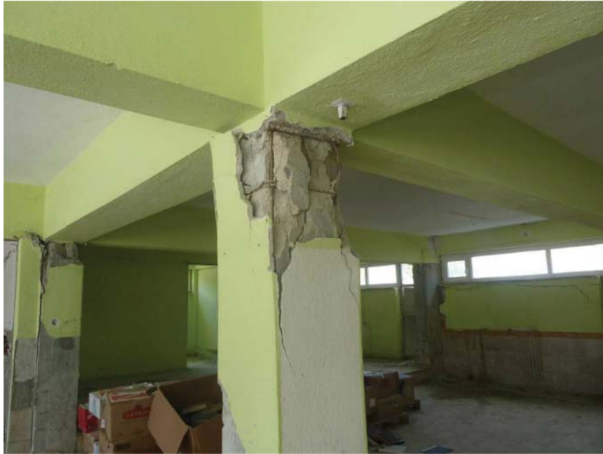
Kolonlar Kirişlerden daha zayıf. (Simav Teknik ve End. Meslek Lisesi- Önceden Boşaltılmış Ek Bina)
