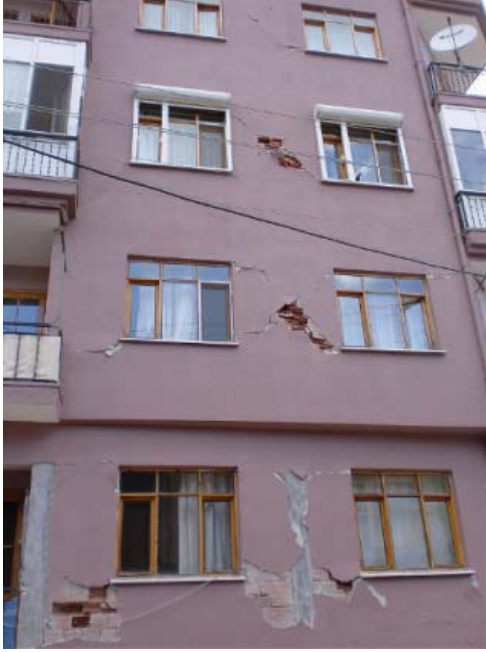
Çok küçük bir çıkmaya oturan ve çerçeve içinde olmayan dolgu duvar hasarı. Hisarardı Mah. Arif Sümer Cad. No:1 adresindeki bina
