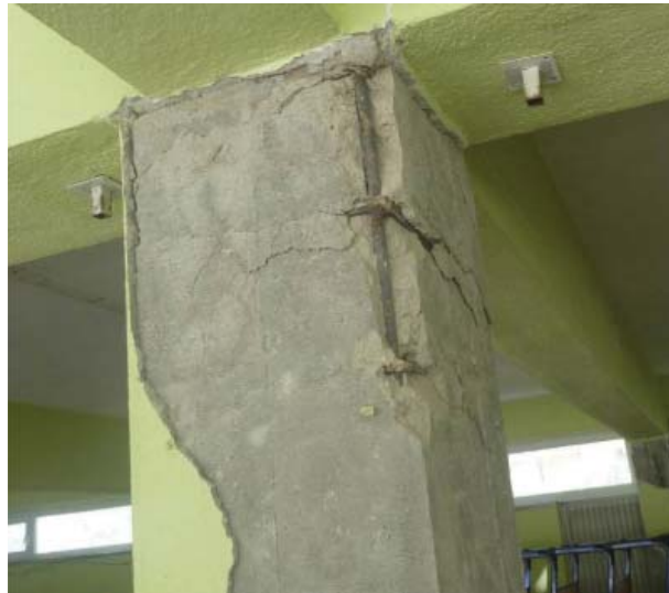
Kolon sarılma bölgesinde Etriye sıklaştırması yapılmamış. (Simav Teknik ve End. Meslek Lisesi- Önceden Boşaltılmış Ek Bina)
