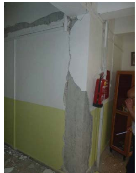
Halk Eğitim binasında Kalın ve gevrek sıvada çatlak ve dökülmeler
