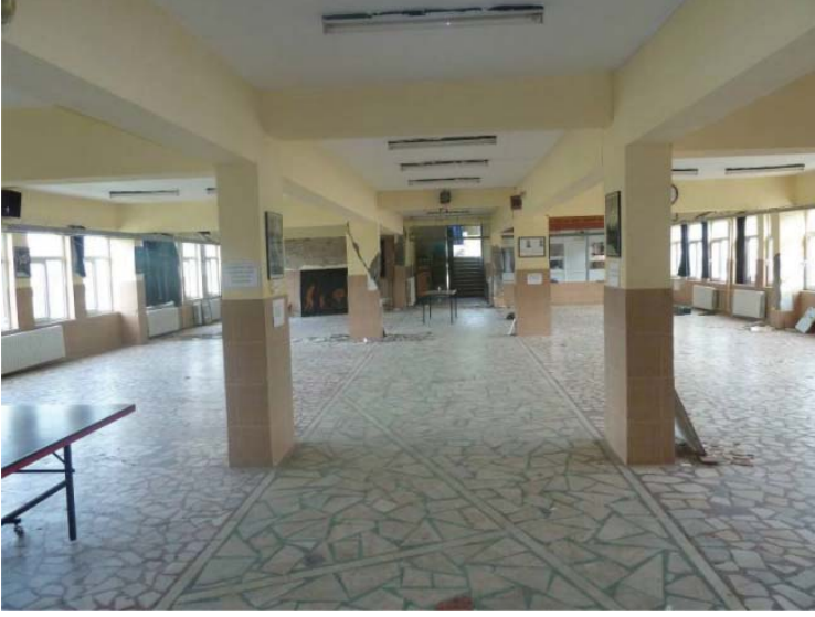
Zemin katta bölme duvarları yok zayıf kat düzensizliği var (Nurullah Kalyoncu Anadolu Lisesi)
