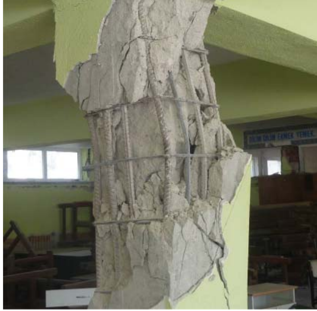
Agregası uygun olmayan beton (Simav Teknik ve End. Meslek Lisesi- Önceden Boşaltılmış Ek Bina)
