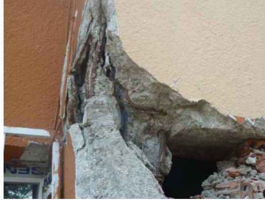
Dış aks köşe kolon- kiriş ek yerinde kolon etriyesinin olmaması nedeni ile düşey donatıların burkulması
