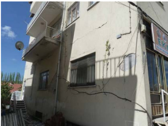
Zemin katında Karamancı Köyü ekmek fırını olan binada çerçeve ile dolgu duvar arasındaki sıva çatlakları ve dökülmeler
