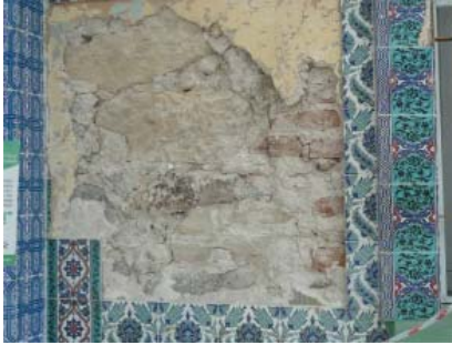
Halil Ağa Caminin taş ve yer yer dolu harman tuğlası ile örülmüş taşıyıcı duvarlarında çatlaklar, üzerindeki kaplama ve sıvalarda dökülmeler.
