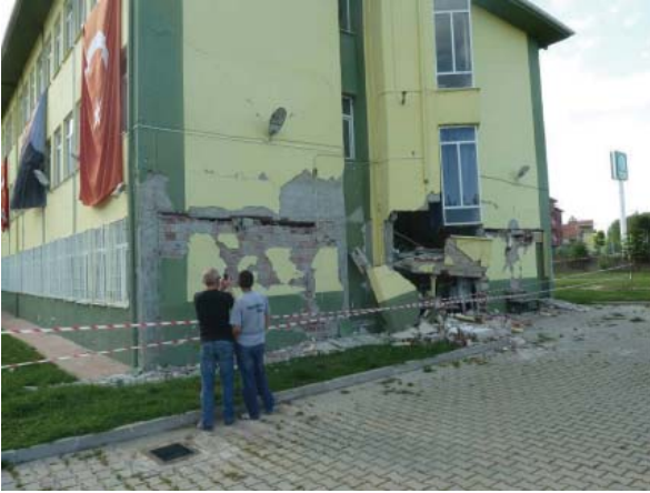
Binanın sağ cephesinde sonradan ilave edilen merdiven sahanlığında göçme
