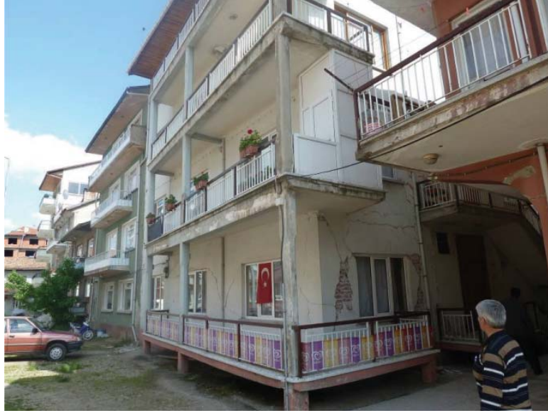
Projesi olmadan gelişigüzel yapılmış yığma bina
