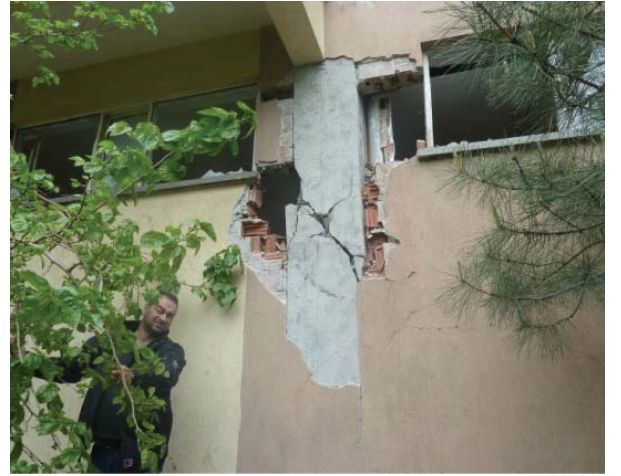
Kısa Kolon hasarı (Ziraat odasının yakındaki, Kışla Cad.No:73 adresindeki Bina)
