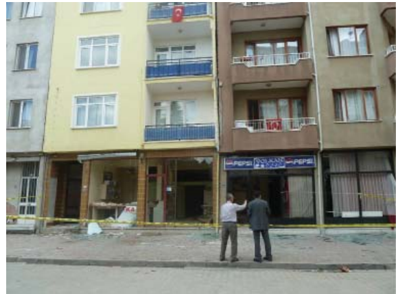
Bitişik nizam yapıların oluşturduğu bloğun en sağındaki binanın zemin katında çarpma ve yumuşak kat nedeniyle kalıcı ötelenme (yaklaşık %2,5)
