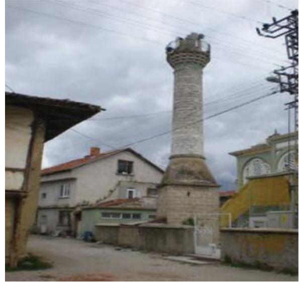
Şerefe üstü yıkılmış minareden bir görünüm
