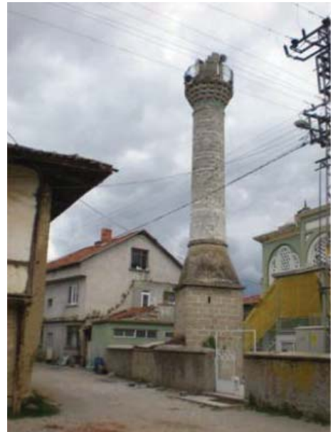
Şekil 3 - Depremde oluşan minare hasarlarından bir görünüm
