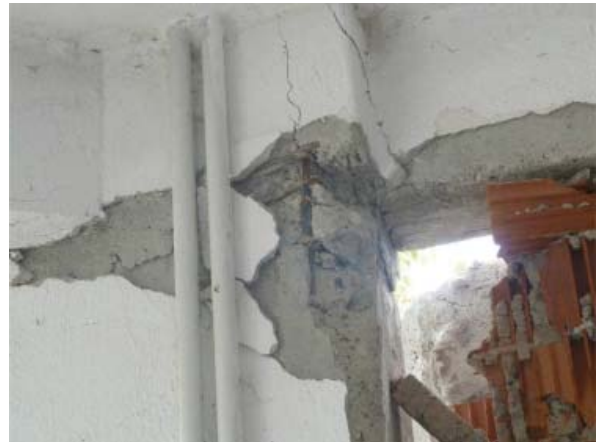
Sulu Oğulları Tarım ürünleri Binası zemin katında orta hasarlı kolon
