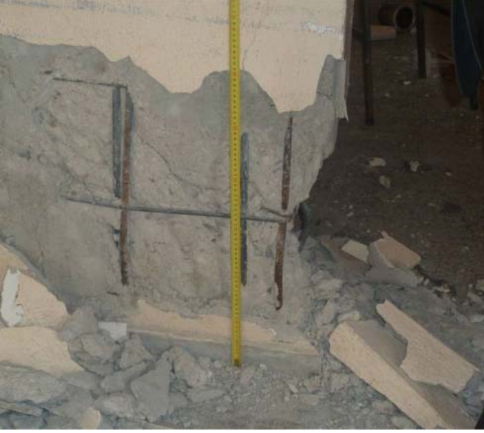
Kolon sarılma bölgesinde Etriye aralıkları 30 cm, sıklaştırma yapılmamış. (Cumhuriyet Cad.No:1deki köşe bina)
