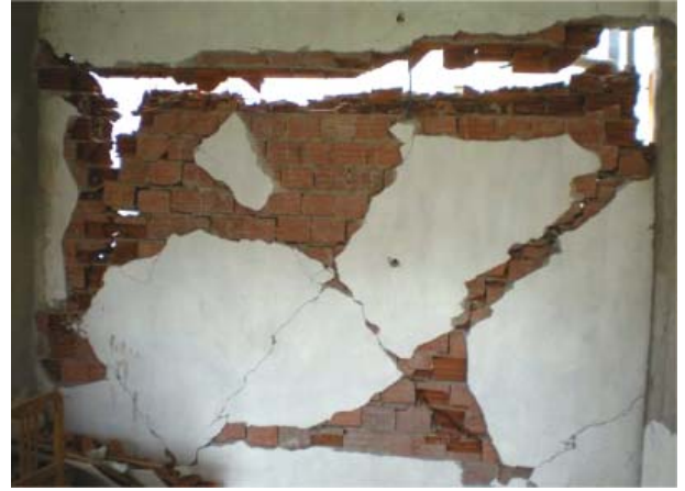
Şekil 1 - Dolgu duvar hasarlarından bir görünüm
