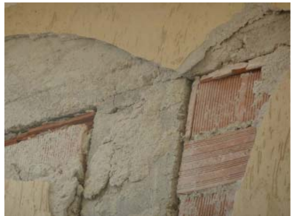
Kolon betonu döküldükten bir müddet sonra kiriş ve döşeme betonunun dökülmesi nedeniyle kolon üst ucunda oluşan soğuk derzler depremde sıvanın dökülmesiyle açığa çıkmış
