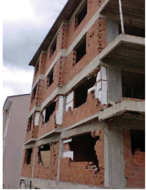
Küçük konsola oturan ve çerçeve düzlemi dışındaki dolgu duvar hasarı. Sandviç dolgu duvarlar arasında strafor olup düzlem dışına kolayca devrilmektedir. (Hisarardı Mah.)
