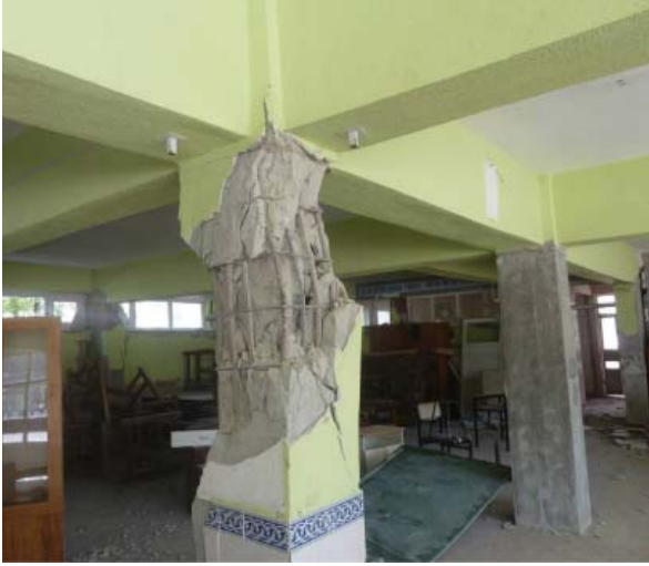
En çok hasarlı Zemin katın görünüşü. Kuvvetli kiriş-Zayıf Kolon Hasarı. Etriye aralıkları 30 cm civarında sıklaştırma yok. Beton granülometrik değil, dayanımı düşük.
