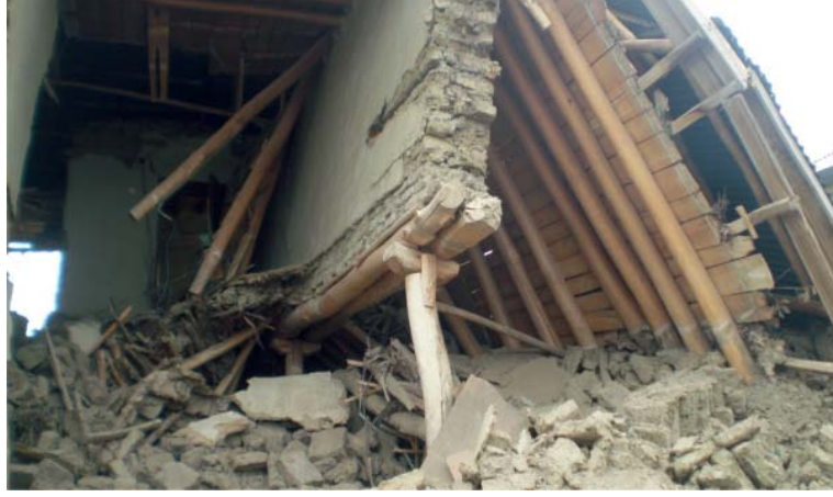
Şekil 6 - Tabanözü köyündeki hasar görmüş kerpiç yapı
