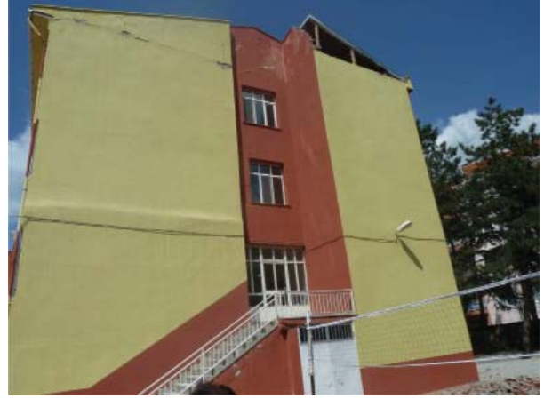
Önceden güçlendirme yapılan Osman Bey İlk Öğretim Okulu. Taşıyıcı sistemde hasar yok. Ancak kalkan duvarı hatıllarla bağlanmadığından yıkılmıştır
