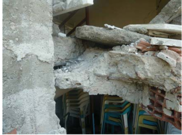
Göçen merdiven sahanlığında uygun olmayan donatı yerleşimi
