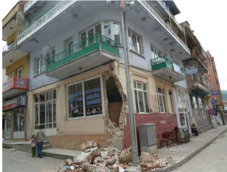
Yönetmeliğe uygun inşa edilmeyen yığma yapı
