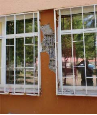
Kolonun ortasında, iri taşlı betonda boşluk olan yerde hasar
