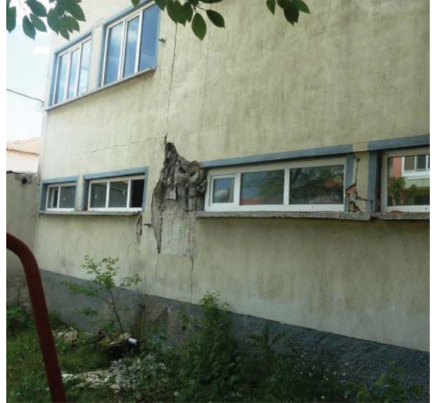
Band pencere nedeniyle oluşmuş kısa kolon hasarı, kesme kırılması
