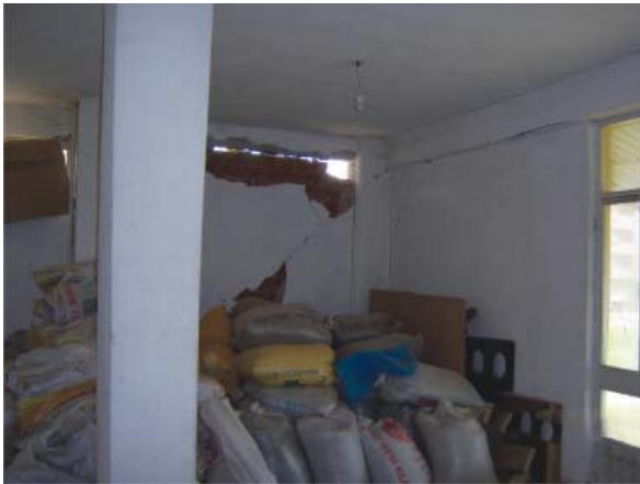
Sulu Oğulları Tarım ürünleri Binası zemin katında Dolgu duvar hasarı
