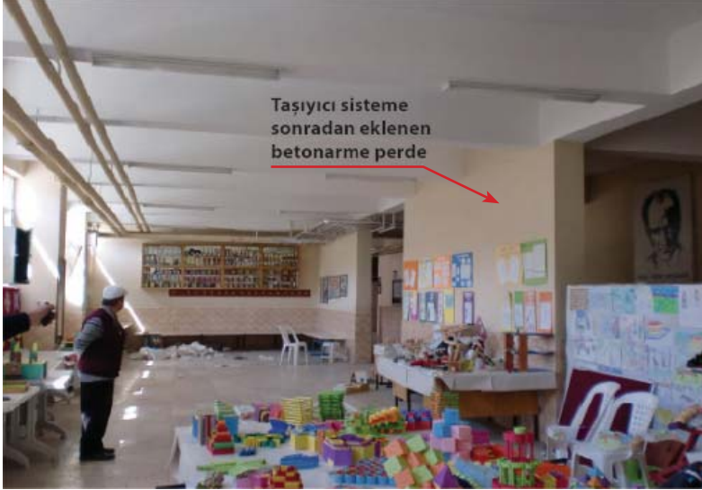
Osman Bey İlk Öğretim Okulunda, yapıya eklenmiş güçlendirme perdesi. Sol taraftaki kolonlardan iki tanesi de mantolanmıştır.
