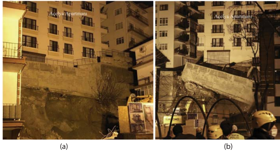
Şekil 8 - 8139 ada 12 parselden yukarıya bakış (9 Nisan 2021 gecesi), (a) kayma öncesi, (b) istinat duvarının yıkılışı
