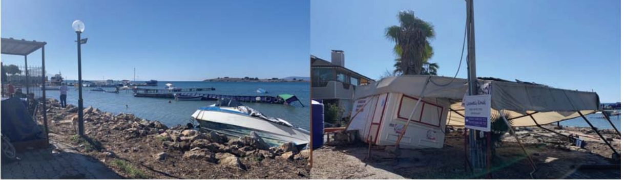
Şekil 3 - Akarca balıkçı barınağında tsunami sebebiyle hasar gören yaşama yeri/iskele yapıları ve tekneler (solda), balıkçı barınağının kıyıda hasar gören tesisleri (sağda)
