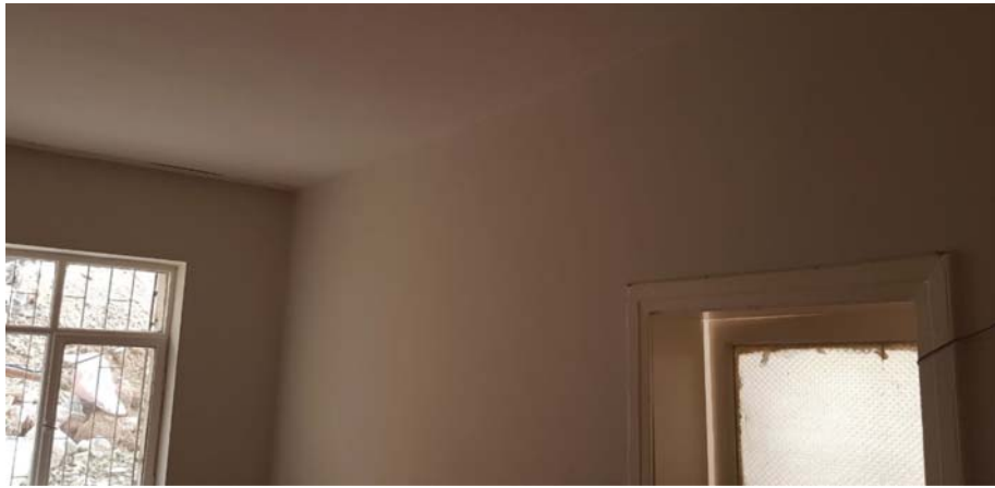
Şekil 18 - Hatipoğlu Apartmanı yıkımın olduğu cephenin içten görünümü
