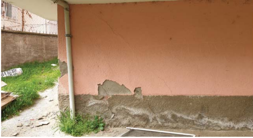
Şekil 27 - Yazıcı Apartmanı'nın (8139/22) göçük yaşanan bölgeye yakın köşesindeki oturma çatlakları
