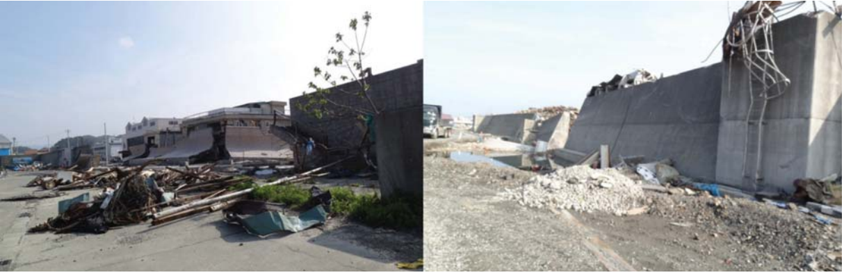
Şekil 6 - Yamada (solda) ve Otsuchi (sağda) kıyı duvarlarına tsunami etkisi
