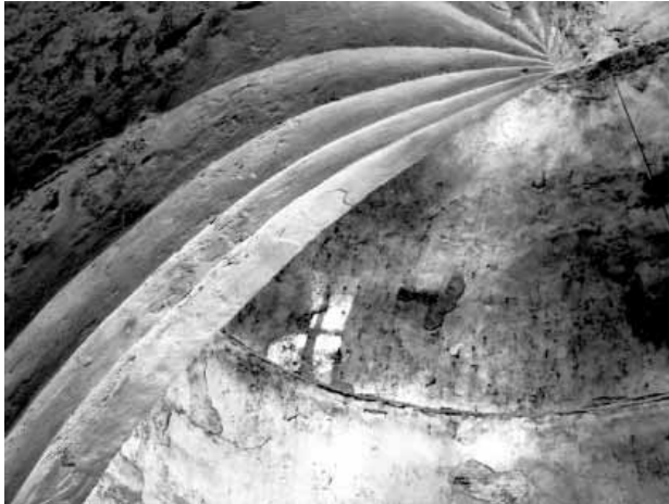
Şekil 8 Soyunmalık kubbesindeki çatlak
